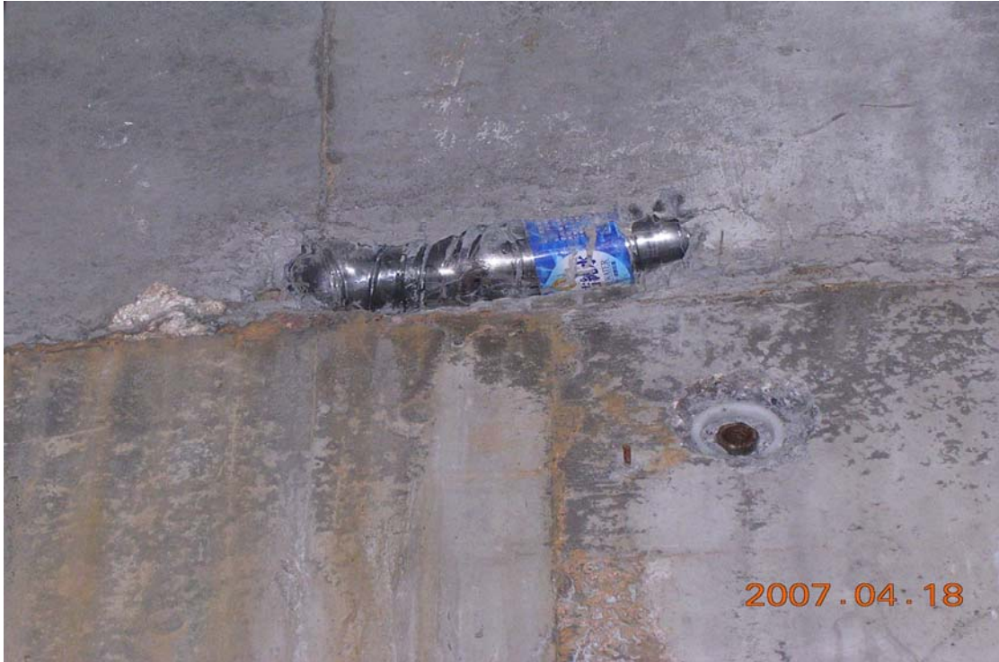
圖九：二號機 EL+12300 之 443 室 RCCV WALL 牆面內有寶特瓶
