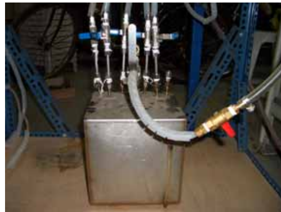
圖 4 富氫氣體導入管路防逆火裝置
