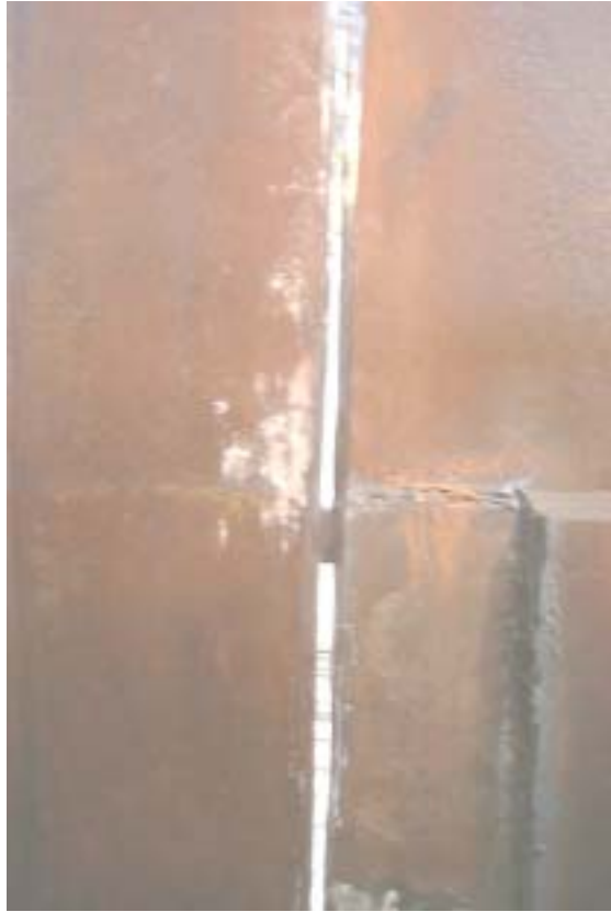
照片五：部分鐸道根部間隙超過規定
