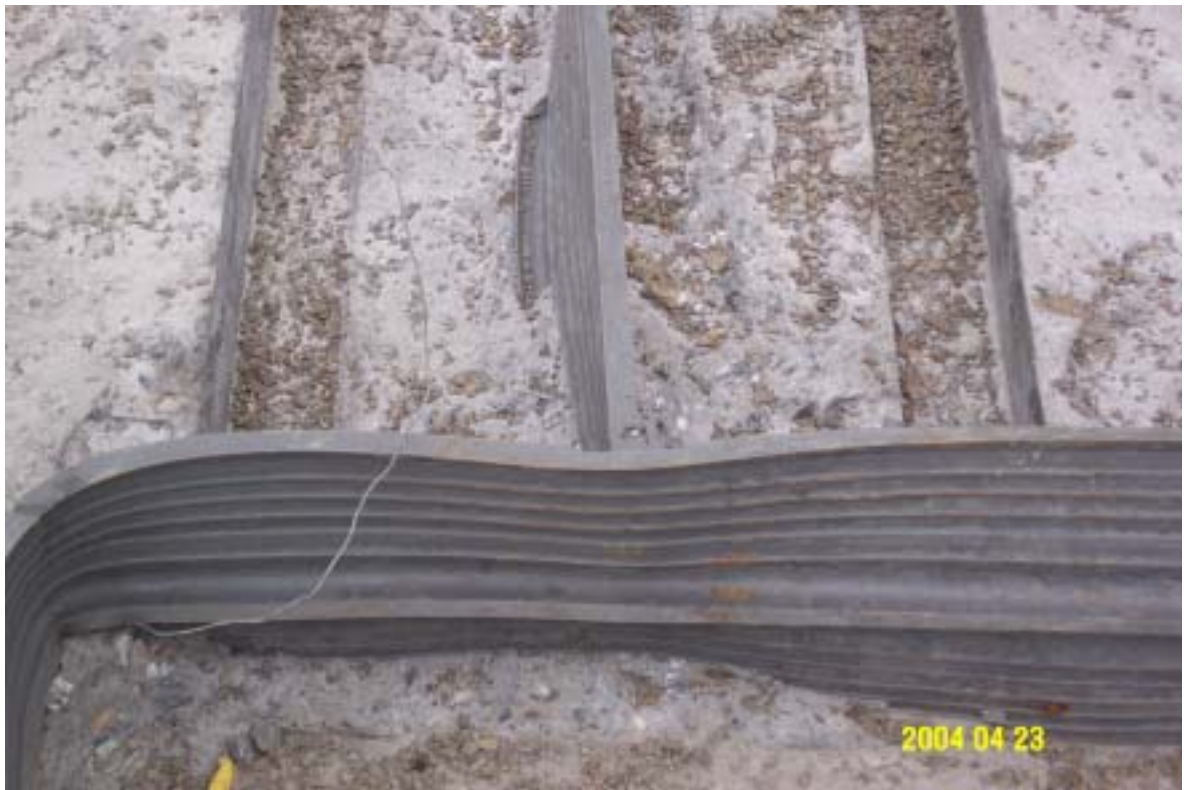
圖一：CWPH 止水帶安裝位置不當混凝土高程不一
