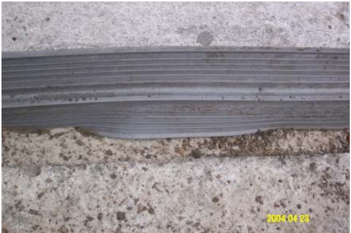
圖二：CWPH 止水帶安裝施工不當另側無混凝土情形（1）
