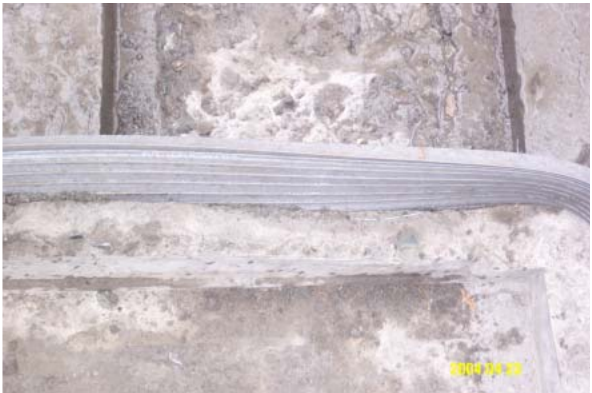
圖四：CWPH 止水帶安裝未隨完成面施作
