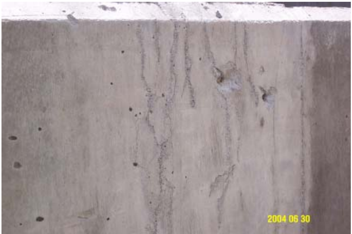
圖十三：CWPH 基座過早拆模致養護水洗刷表面混凝土情形
