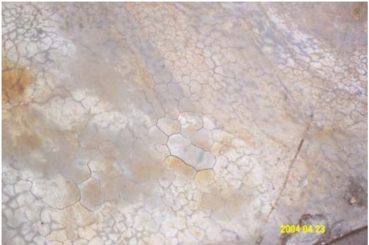
圖五：CWPH 基座混凝土完成面龜裂情形
