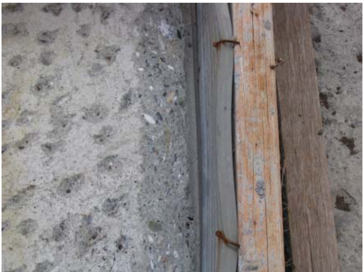
圖十四：CWPH 基座第二區塊止水帶澆置不收縮水泥漿應鑿除混凝土厚度不足 3 cm情形
