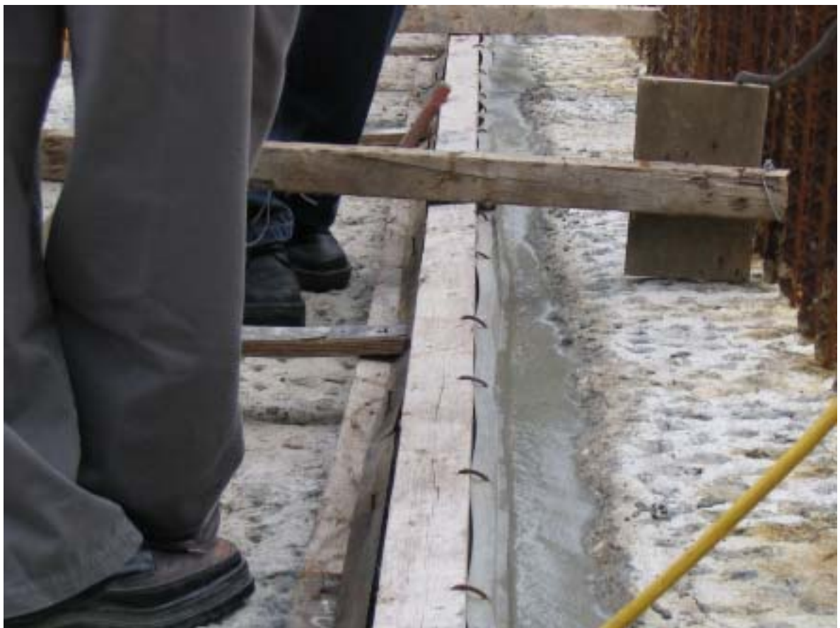
圖十六：CWPH 基座第二區塊止水帶改善不當的單側施工情形
