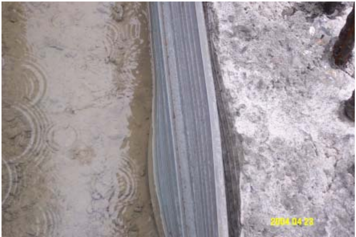
圖三：CWPH 止水帶安裝施工不當另側無混凝土情形（2）
