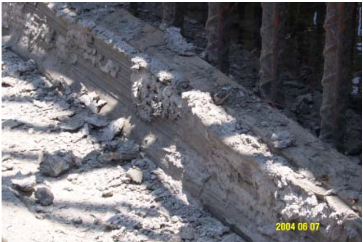
圖六：CWPH 基座第三區塊混凝土澆置後表面凌亂情形
