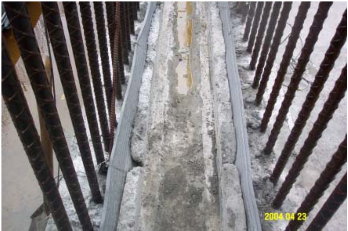
圖八：CWPH 外牆兩道止水帶混凝土圍束厚度不足情形
