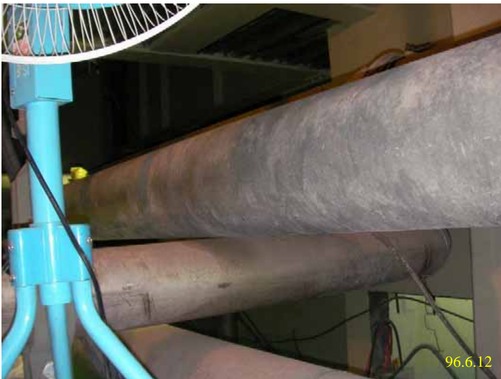
照片十：RBCW 與 CSTF 管路上下交錯疑似過於接近情形
