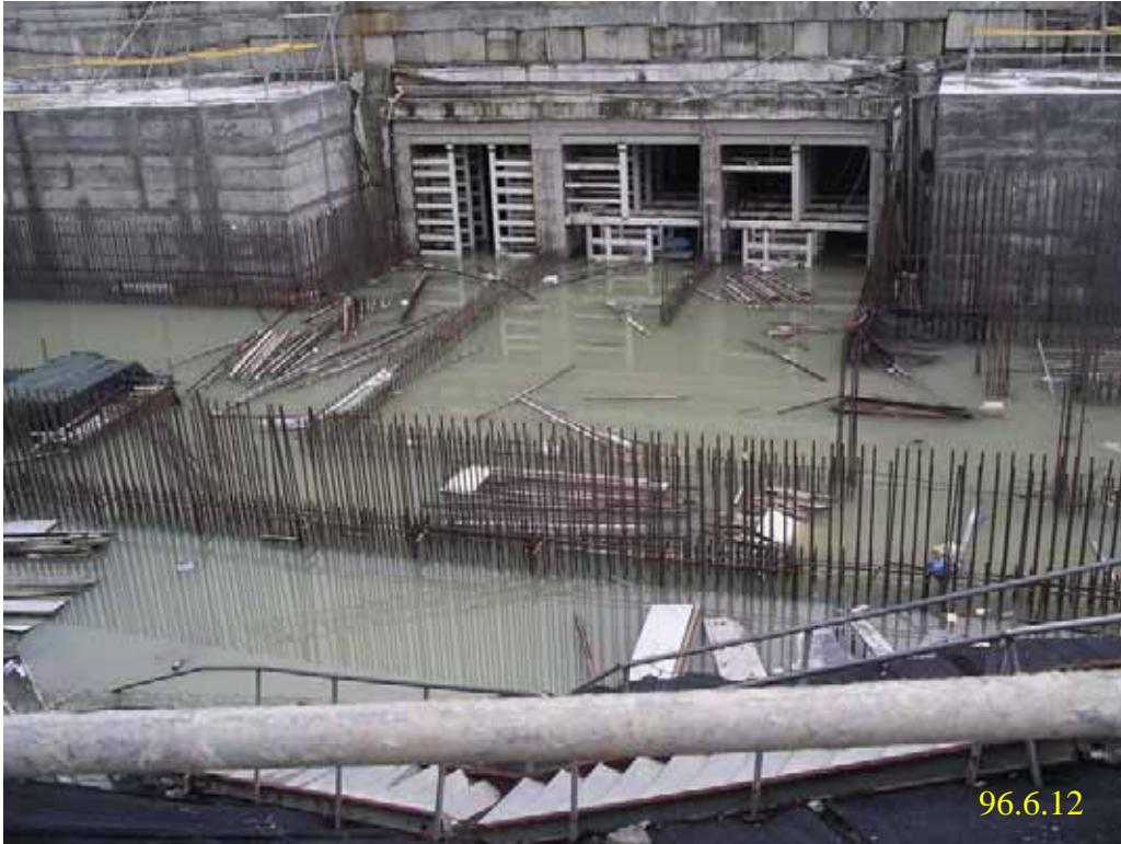
照片十二：核廢料隧道積水情形
