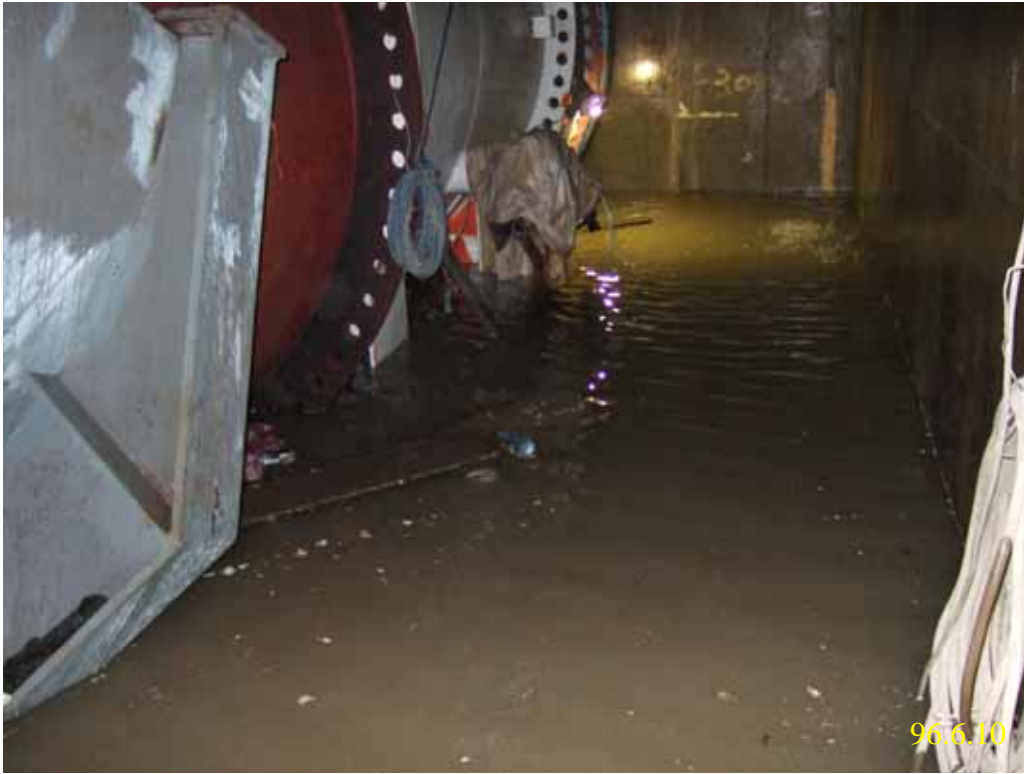
照片十三：一號機汽機廠房底層 EL+4500 積水情形
