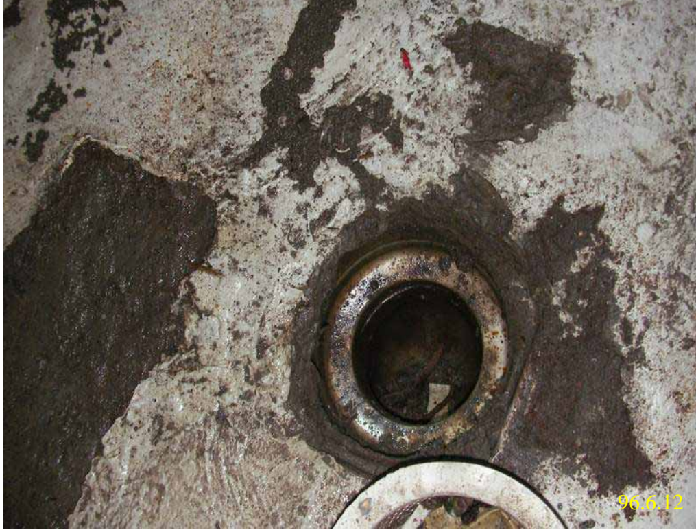
照片十一：地板洩水口充滿雜物情形
