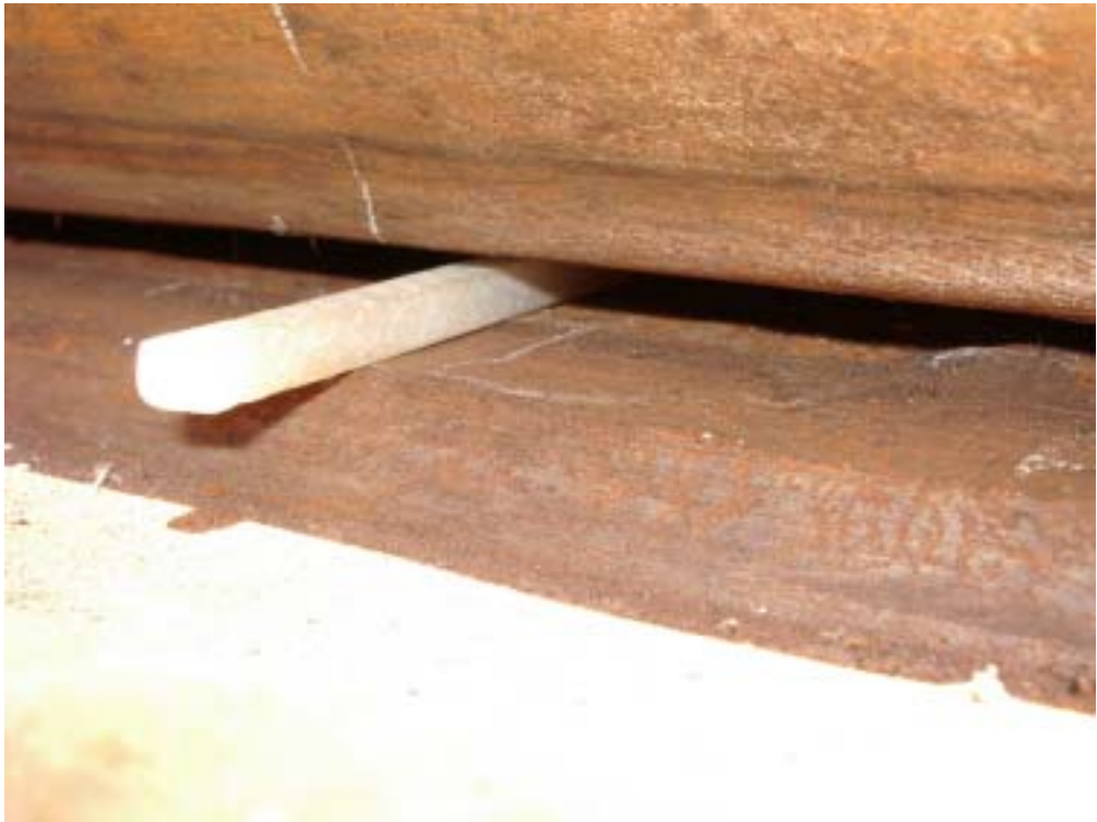
照片三：基礎鐸道背襯鈑與基鈑間隙過大情形(一)
