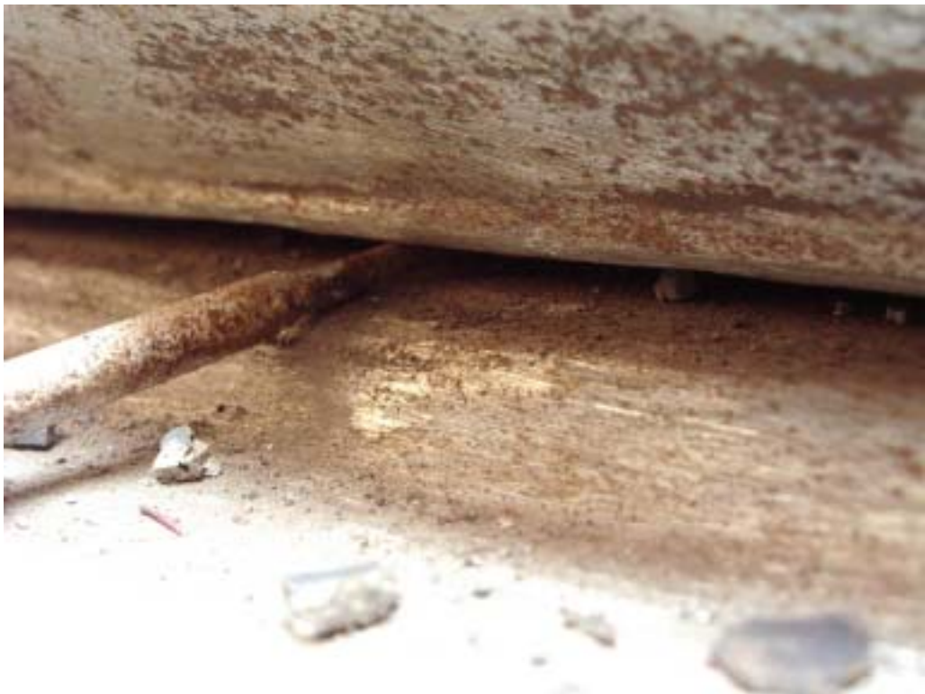
照片四：基礎鐸道背襯鈑與基鈑間隙過大情形(二)
