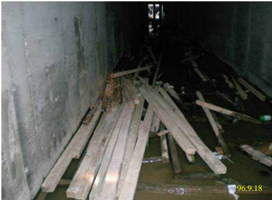
照片十一：一號機 RBSW 渠道木架及垃圾散落嚴重積水情形
