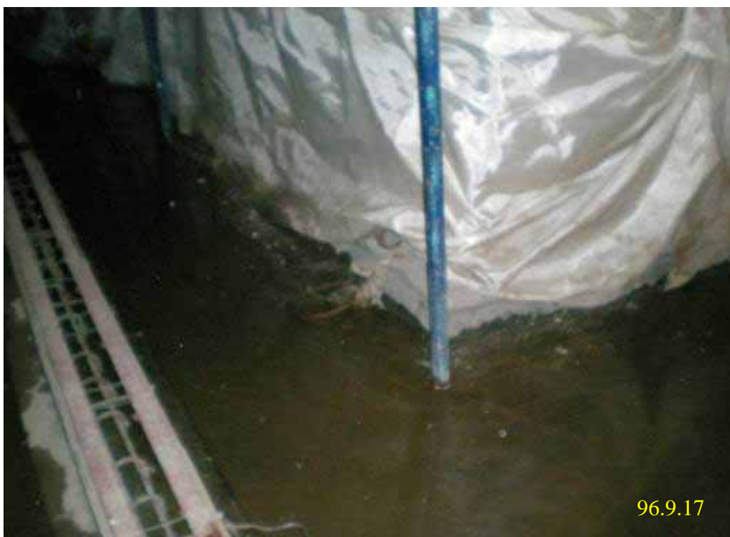
照片九：一號機 ECW 泵浦設備基座四周地面嚴重積水情形
