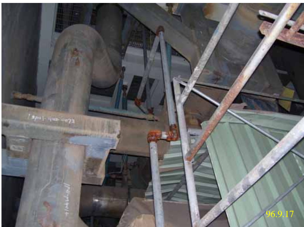
照片八：一號機 RBCW 系統已安裝之管路明顯生銹情形
