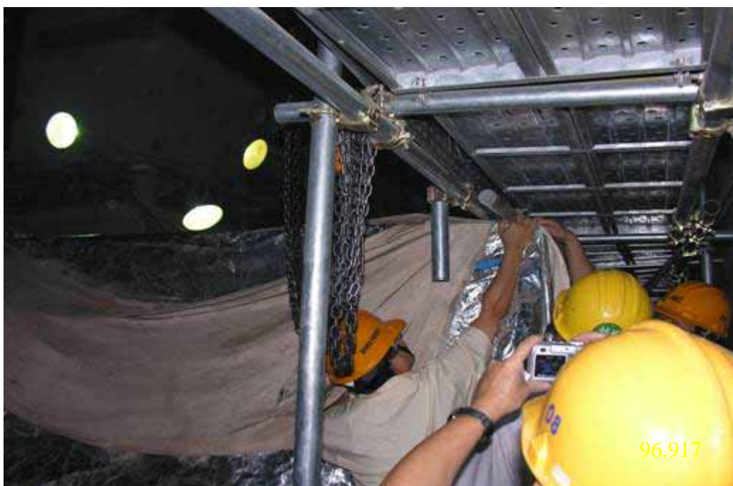
照片七：工作鷹架直接搭在廠用空氣系統空壓機上情形
