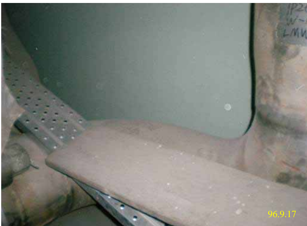
照片十：一號機 RBSW 管路被擺設木板及梯踏板情形
