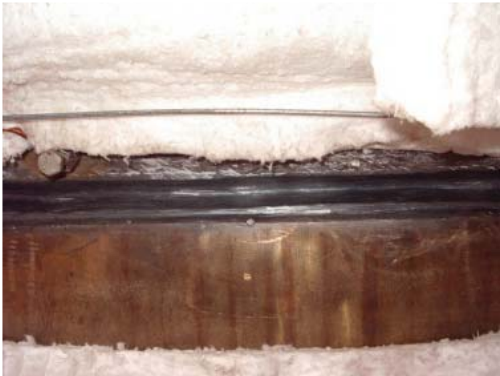
圖七：第二次試鐸前 WN23 鐸道(缺陷#59 位置)情形
