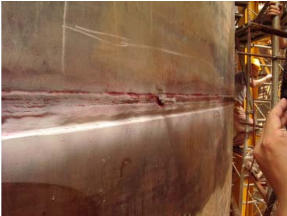
圖九：第二次試鐸後 WN23 鐸道 PT 檢測給果(第 59 號缺陷)
