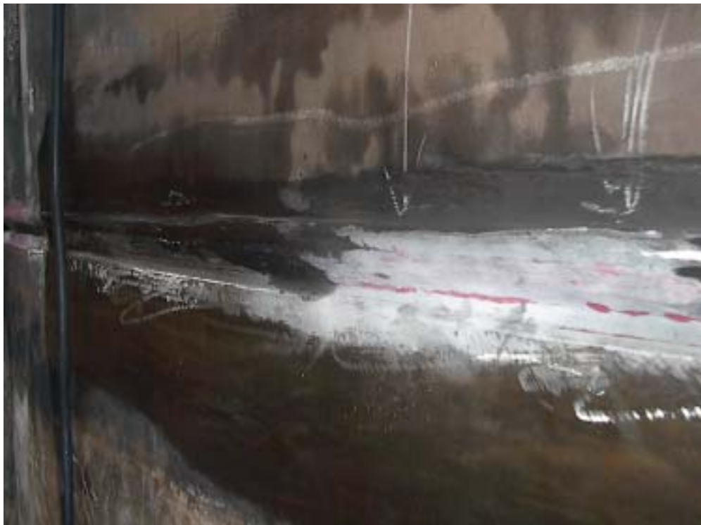
圖四：第一次試鐸補鐸後龜裂位置(紅色線條)
