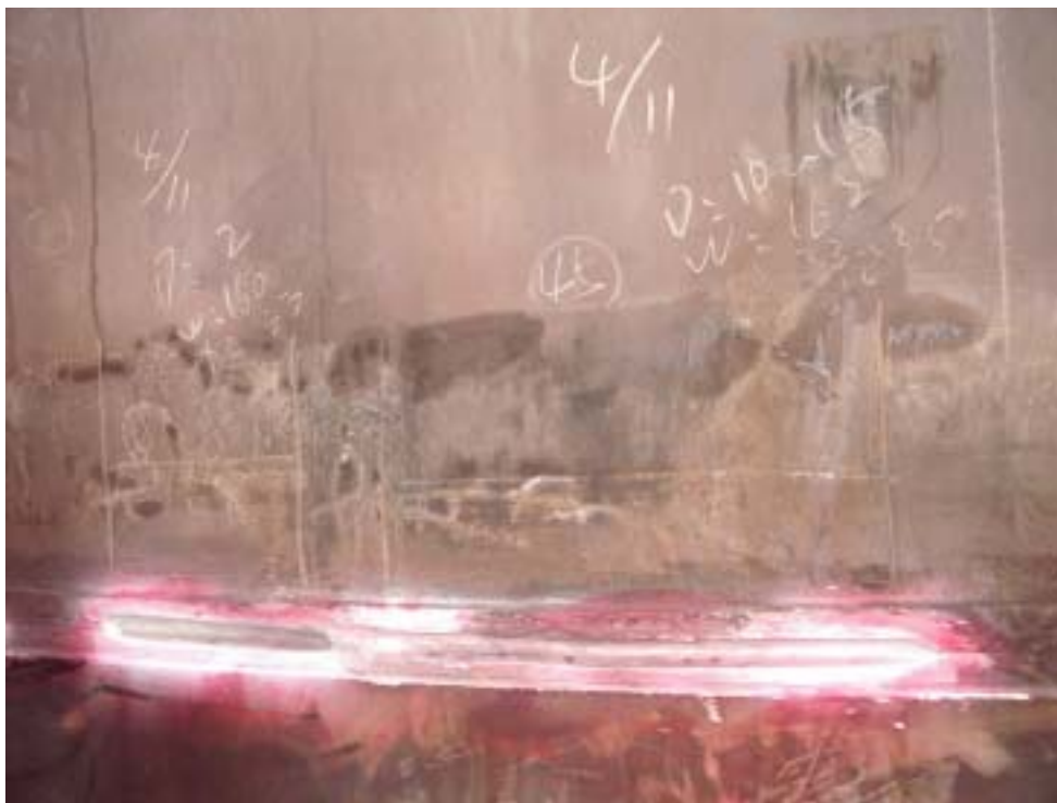
圖二：WN23 鐸道缺陷(第 45 號)磨除後情形
