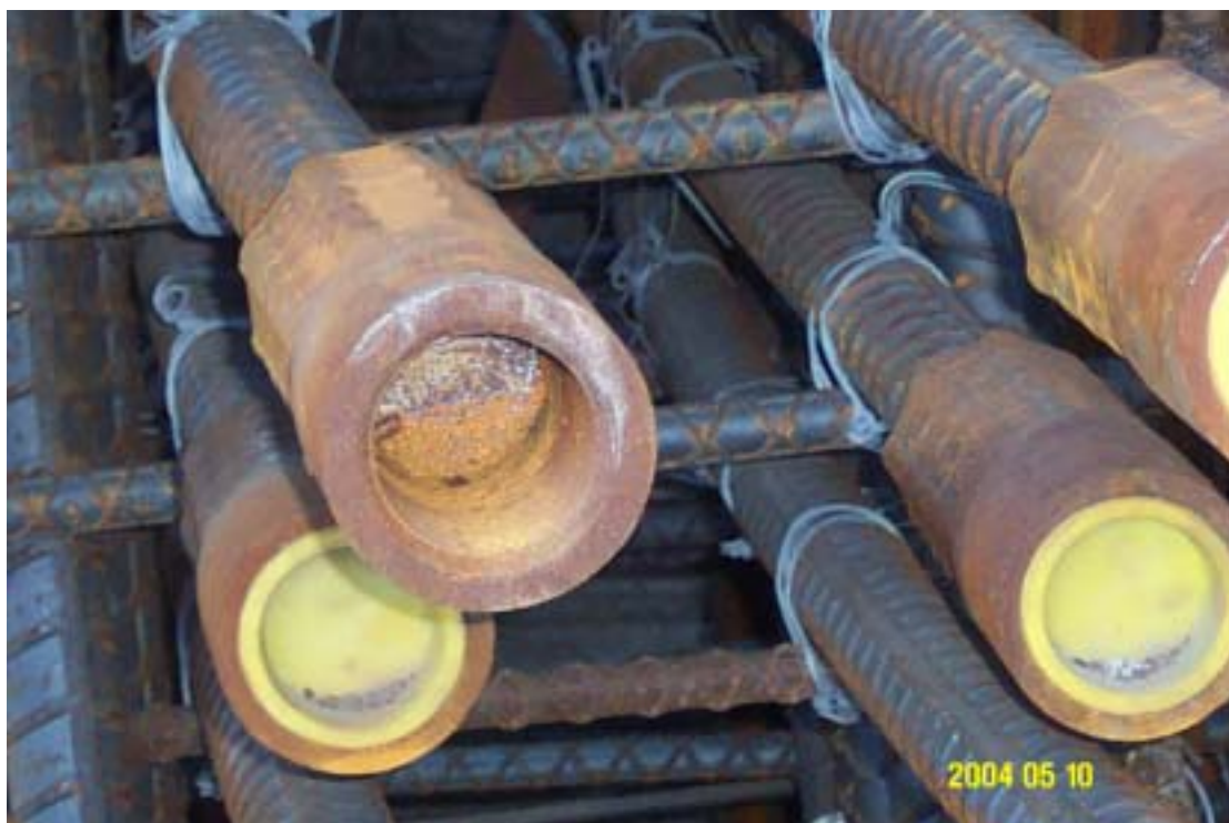
圖三：萬向接頭帽蓋脫落情形
