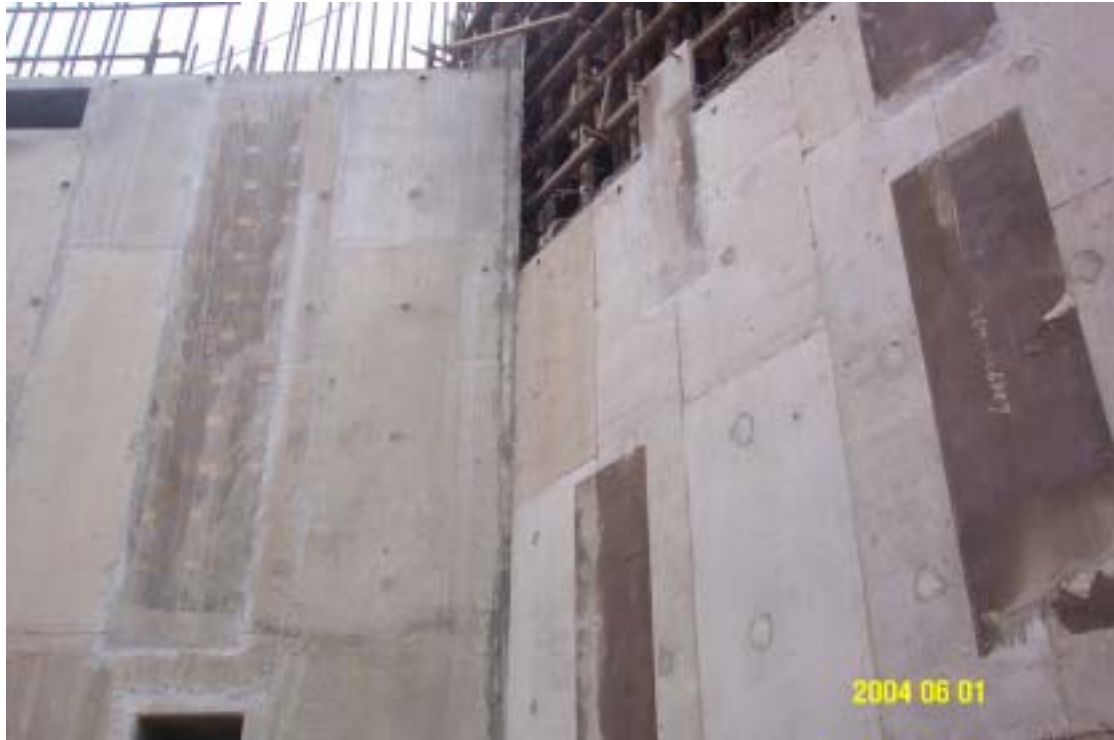
圖十五：施工縫未檢驗表面已完成水泥砂漿修補情形
