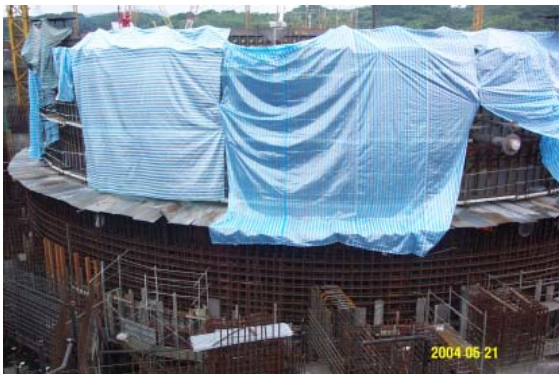
圖二：遮雨棚及帆布架設防護情形
