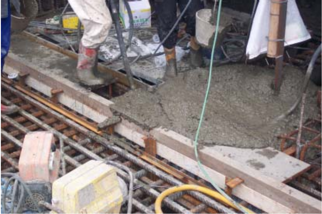
圖九：混凝土搗實作業執行時震動棒未垂直插入情形
