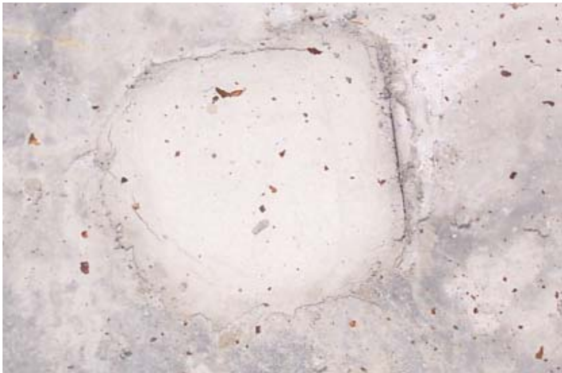
圖十四：工作角鋼切除以混凝土修補後形狀不規則 且邊緣均發生裂縫之情形
