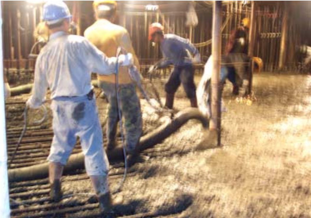
圖七：混凝土直接澆置於頂層鋼筋上現況
