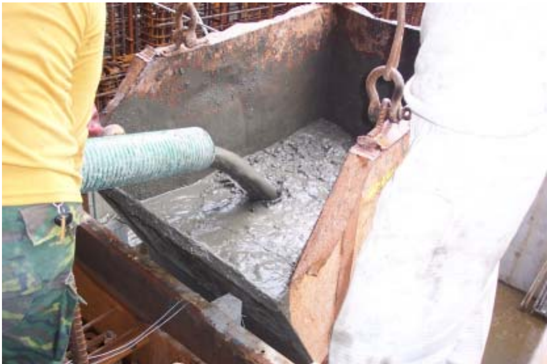
圖六：潤管用水泥砂漿洩入廢料槽內
