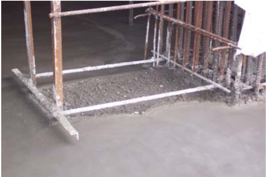
圖十一：完成面應表面粉光卻以粗造面處理情形
