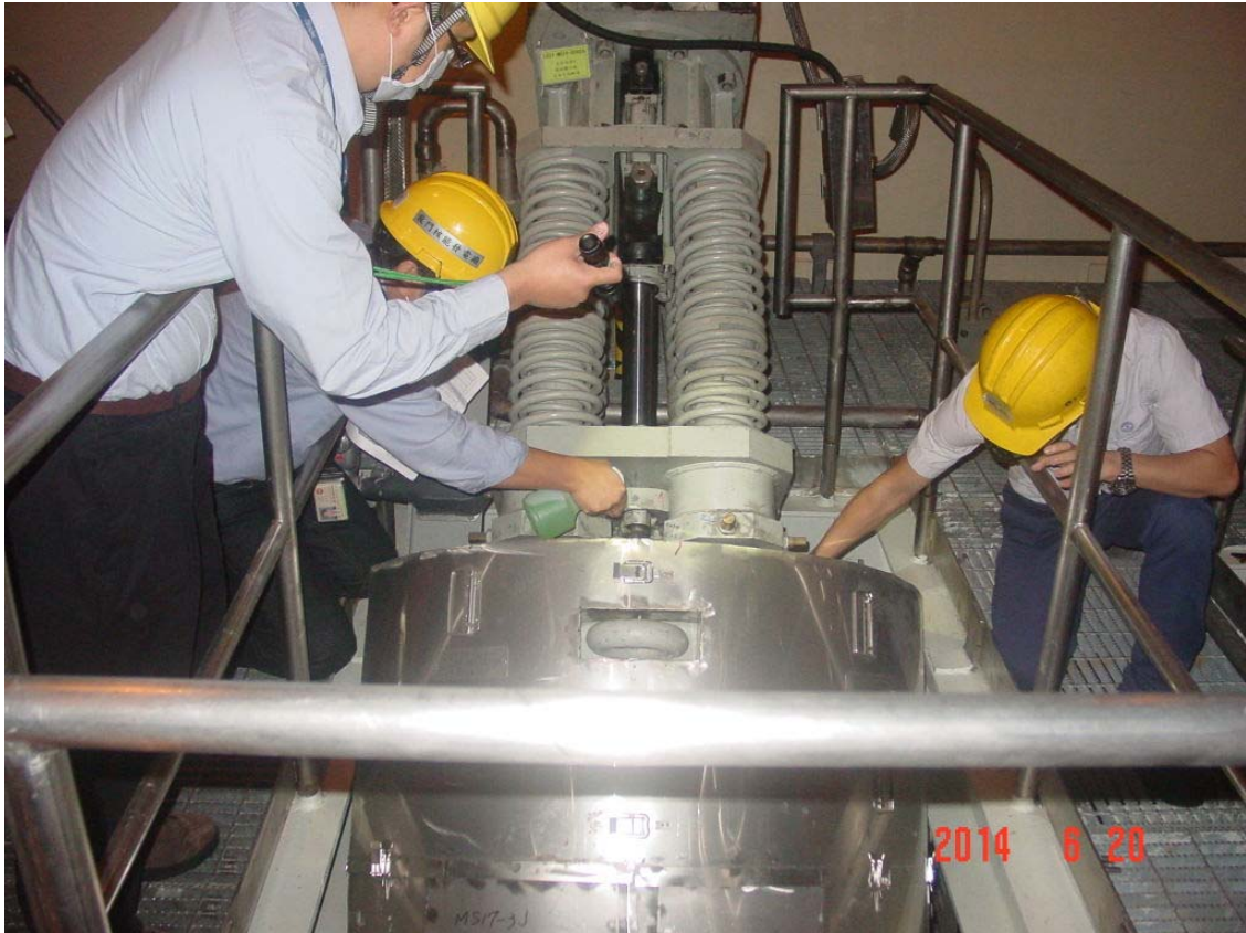
照片 3：查漏人員查看主蒸汽隧道內 MSIV
