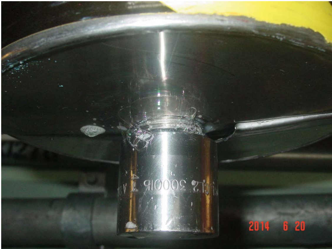
照片 4：1T62-BV-0441 下游 cap 微漏
