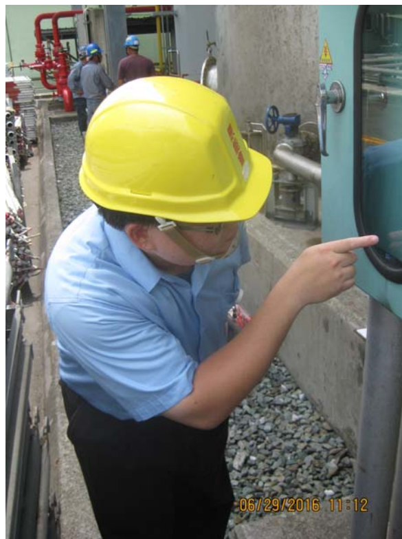
照片 2：沉水泵控制盤查證
