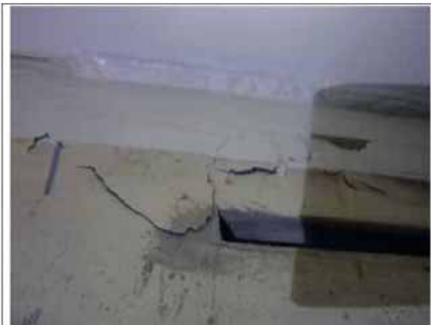
編號129之 Div III 儀器架室內之西南角牆面混凝土破裂結構損害情形
