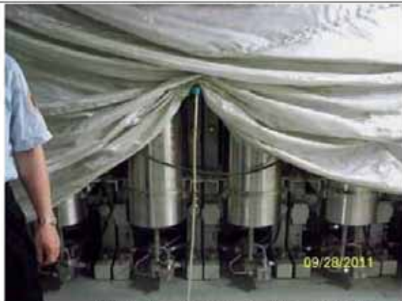
#2 DIV. II 儀器架室：防塵布未確實覆蓋儀器。
