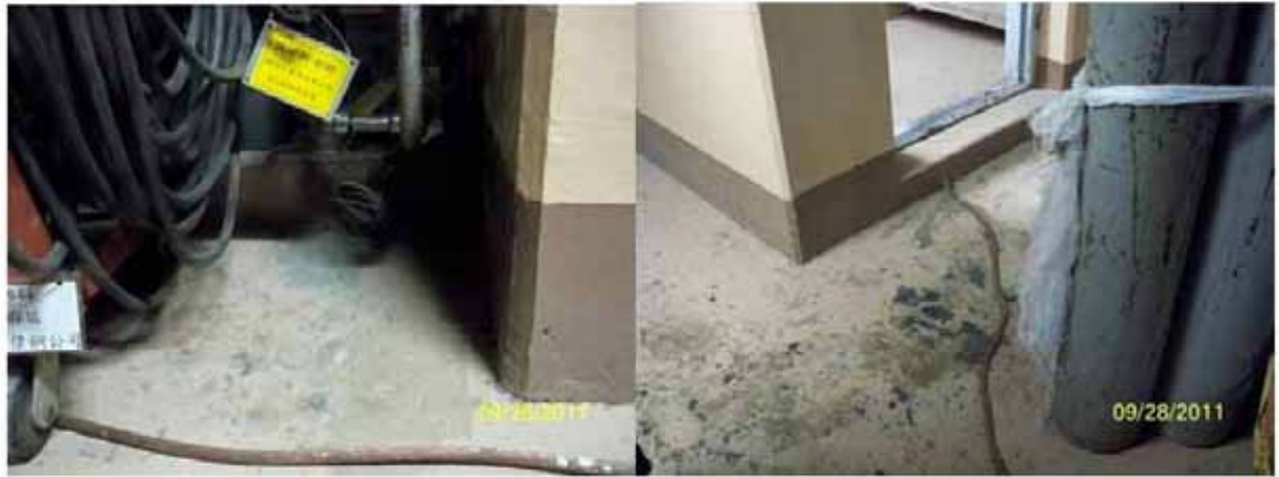
二號機反應器廠房 1F 西北側樓梯間：地面接地銅線凌亂，未使用線夾整齊固定於牆邊，有工安疑慮，且疑似未依施工規範施工。
