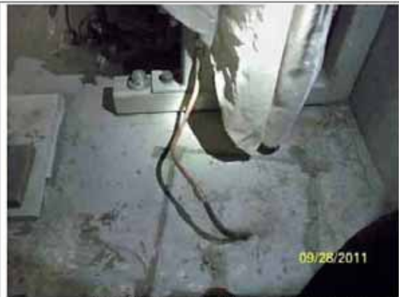
#2 DIV. II 儀器架室：地面接地銅線凌亂，未使用線夾整齊固定於牆邊，有工安疑慮，且疑似未依施工規範施工。
