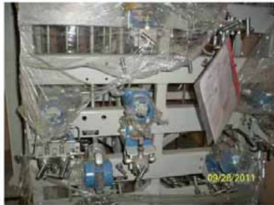
#2 DIV. II 儀器架室：部分儀器盤(2H21-IRK-0116)防塵布破損。
