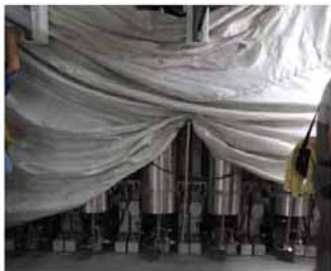
防塵套未完全遮蓋且有破損情形
