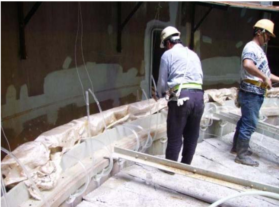
圖 6：二號機基座之 RPV 支撐座二次澆置不收縮水泥漿情形
