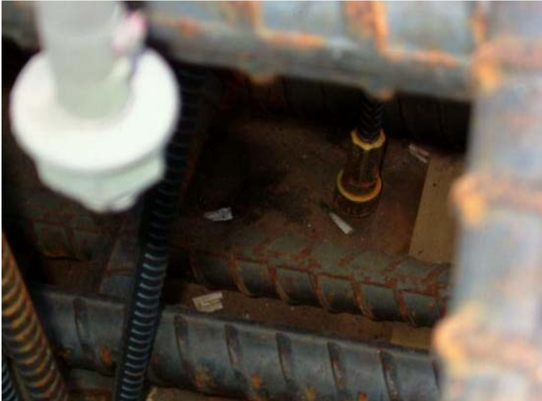
圖 9：二號機 D/F 樓版雜物未清情形
