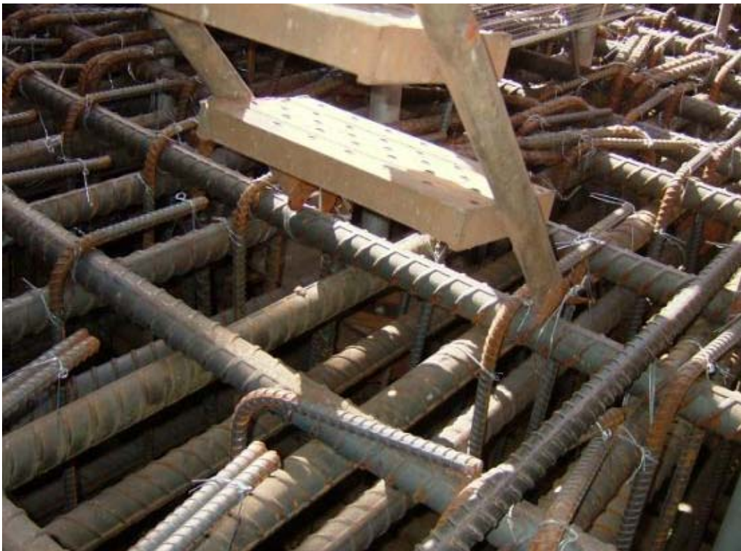
圖 8：二號機 D/F 樓版剪力筋遺漏未組立情形
