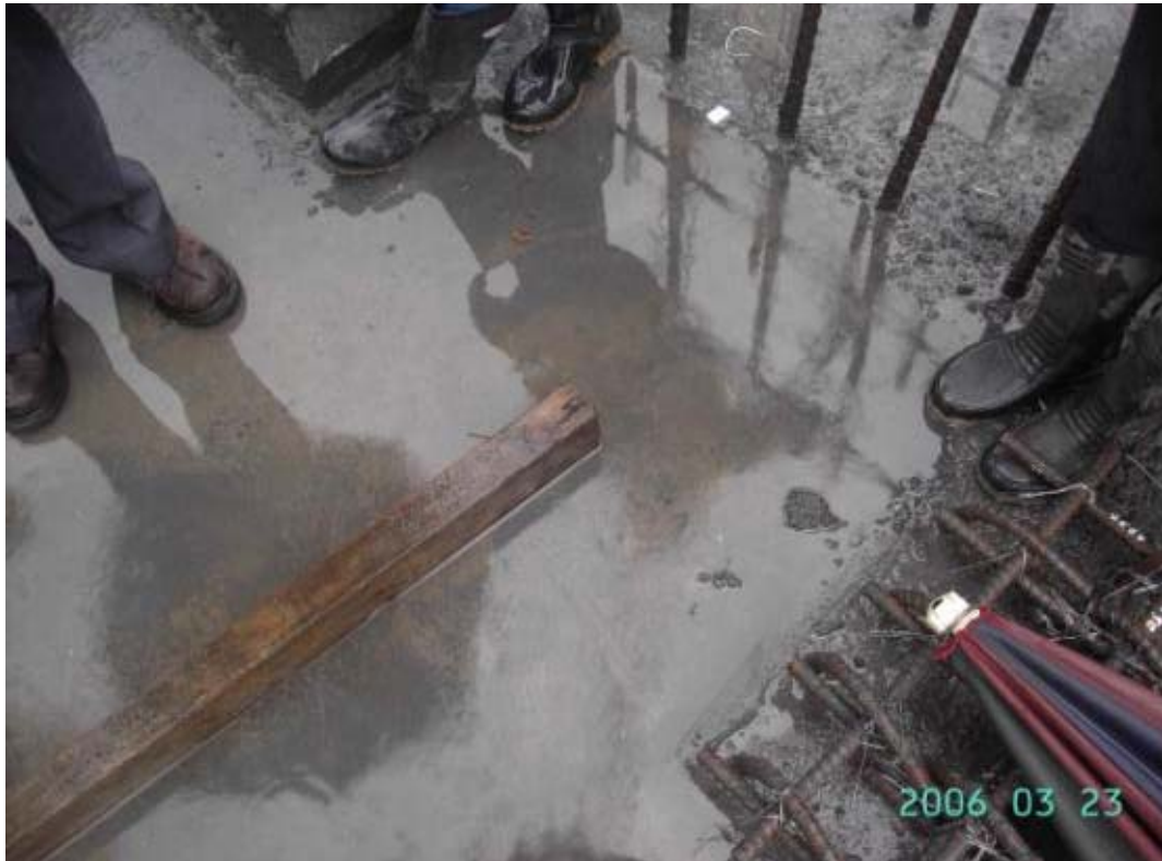
圖 11：樓版洩水孔以混凝土封蓋情形（角材端點位置）
