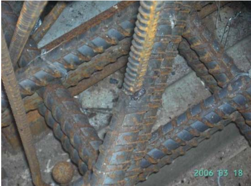
圖 3：未完成改善之斜向鋼筋情形
