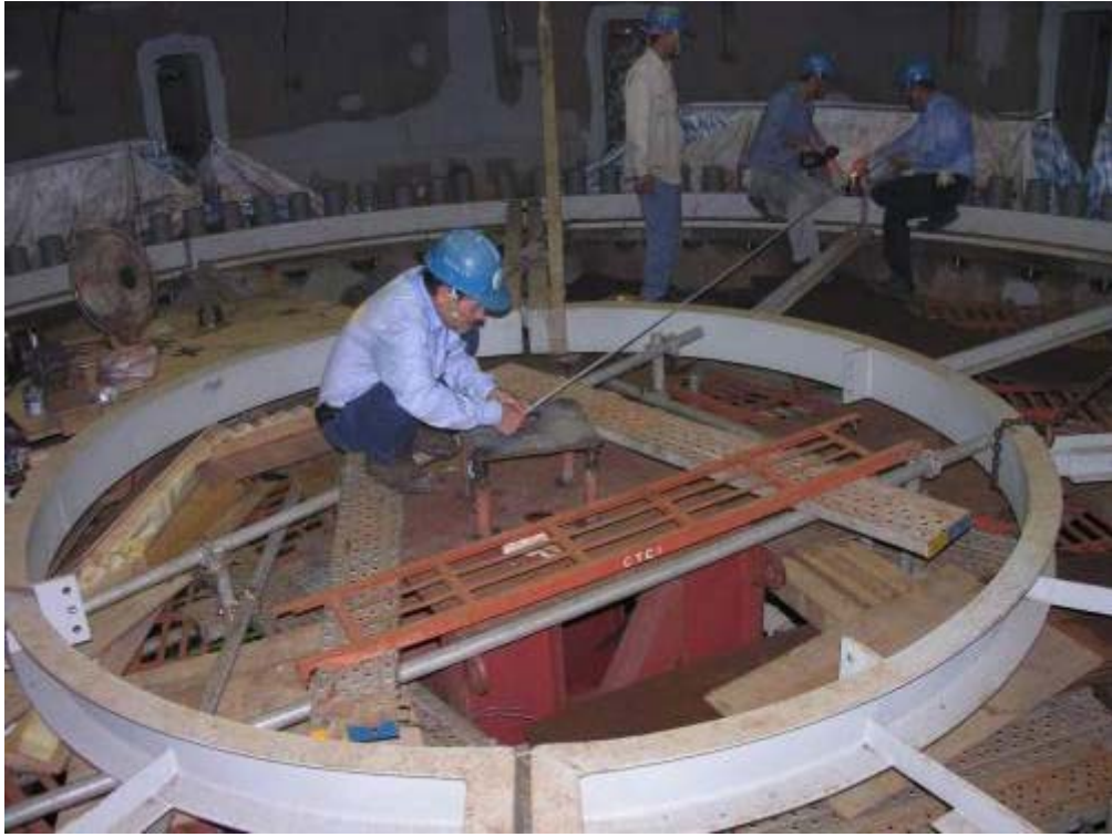
照片二十五、Support Skirt Flange 上反應器基礎螺栓安裝後量測情形(一)
