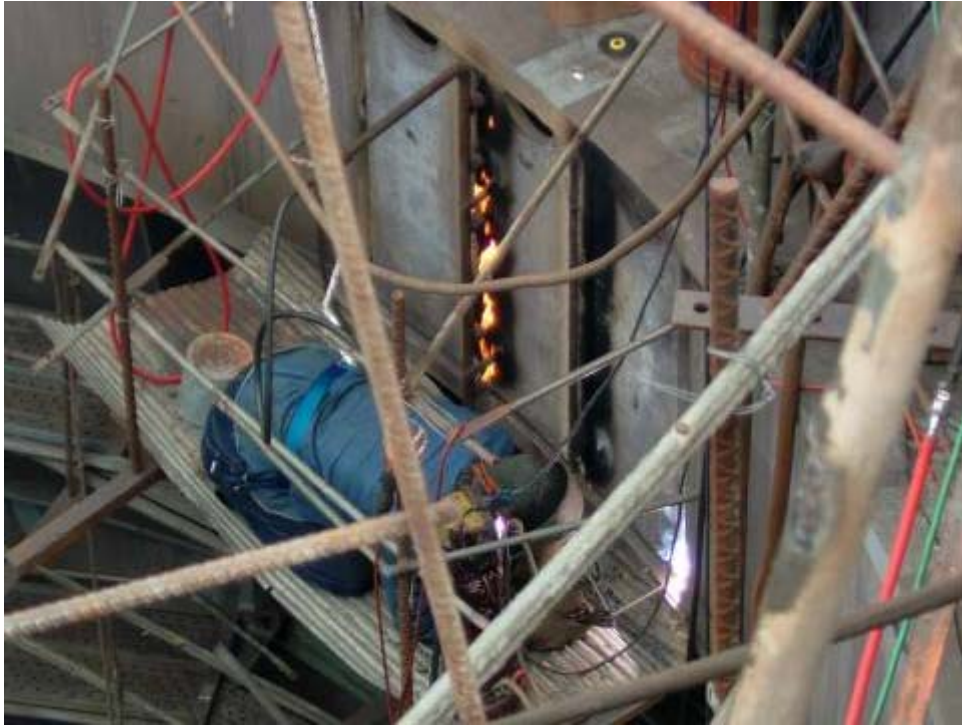
照片十七、基座第三層 Support Skirt Flange 外封鈹施鐸情形
