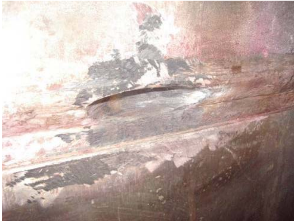
照片七、WN23 鐸道鐸接缺陷移除後情形
