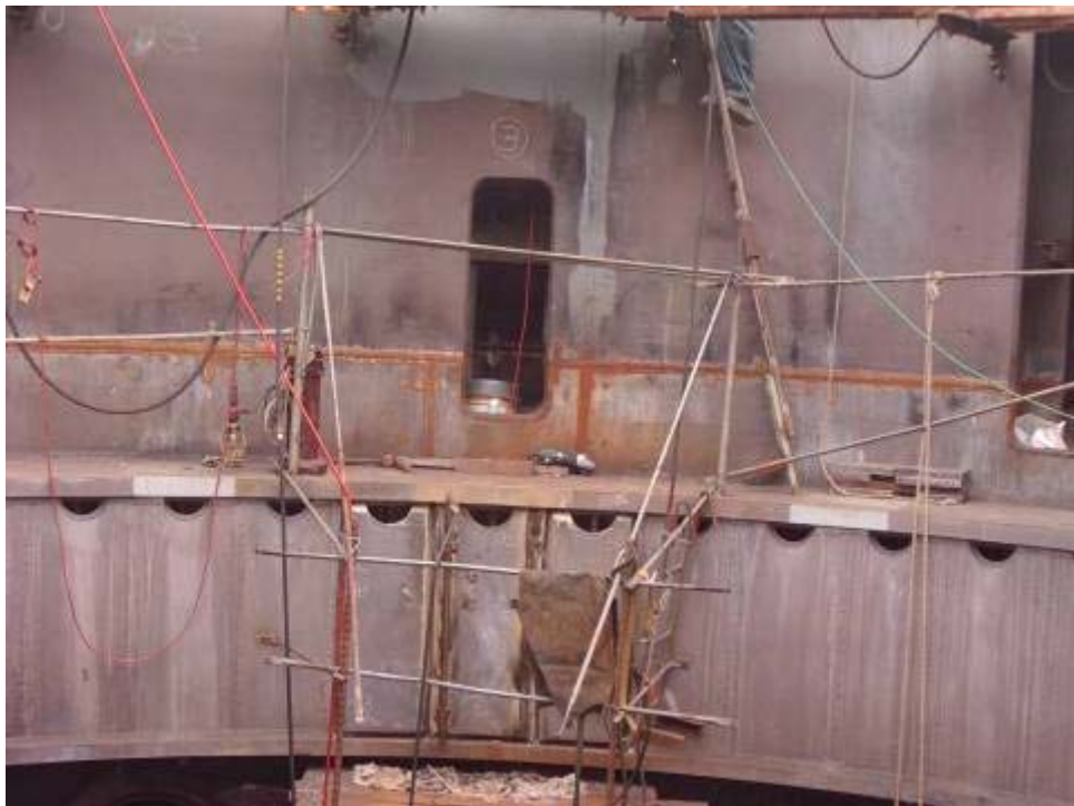
照片十六、基座第三層內鈹現場預留封鈹施鐸後情形(通風口下方)
