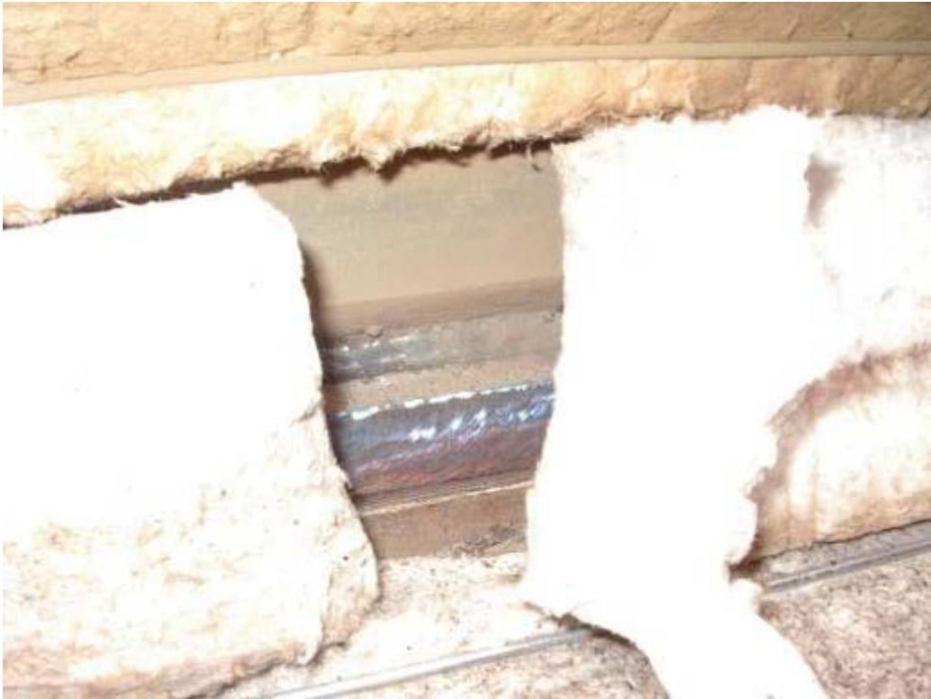
照片一、基座第一、二層間 WN23 鐳道電熱片及保溫毯裝置完成後情形
