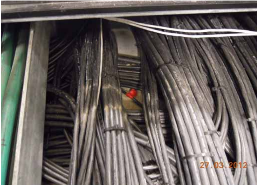
照片五 一般電纜區仍發現有安全級顏色標示
