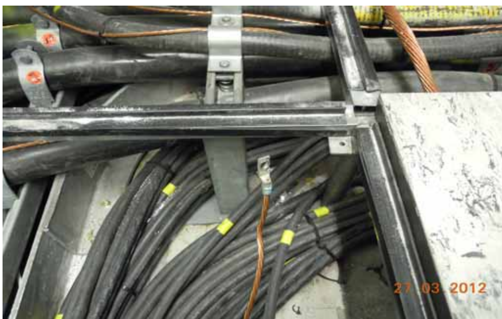
照片二 抽查電纜數量時，發現期間多拉設一條閒置不用之光纜
