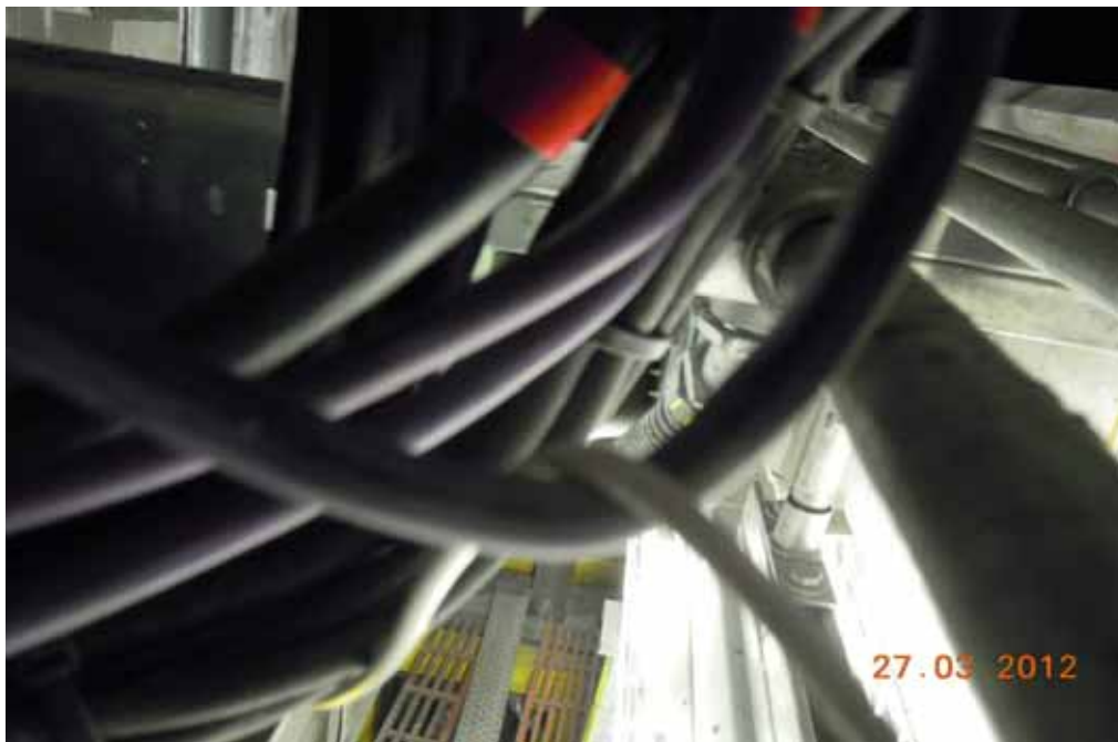
照片四 電纜上掛有臨時通訊電纜
