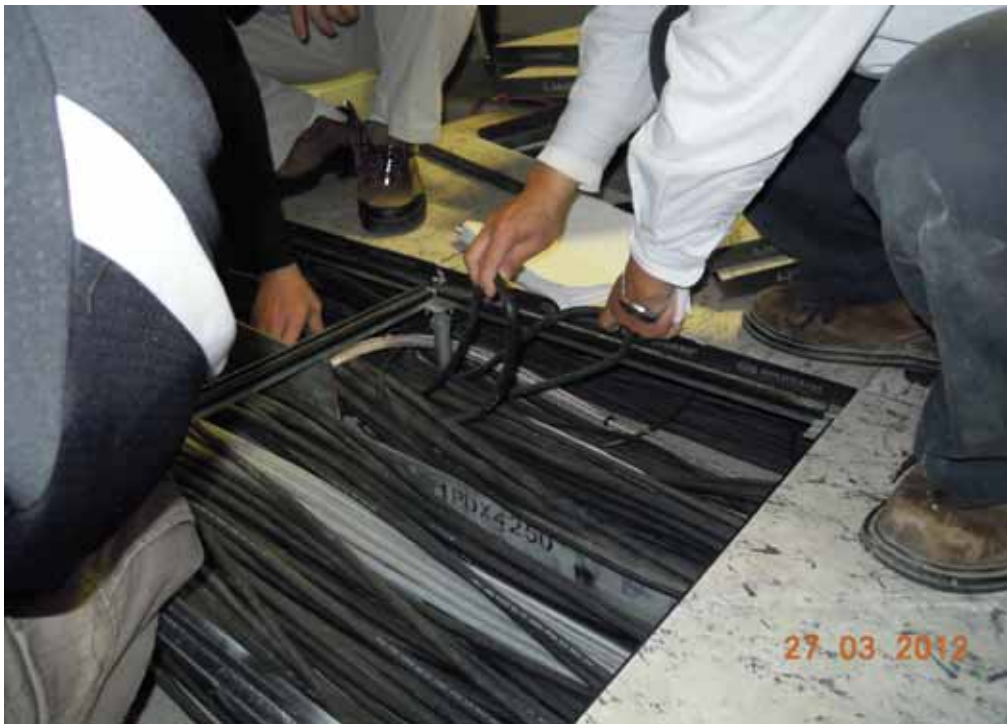
照片三 電纜外被覆有折角痕跡
