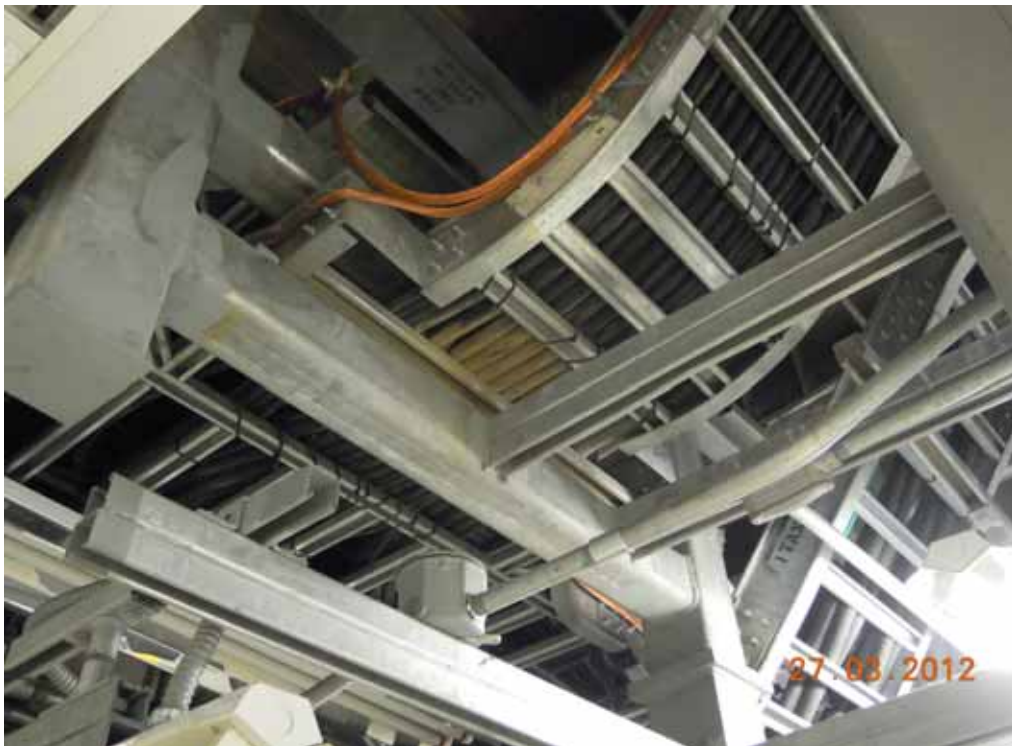
照片六 電纜線外明顯被覆一層灰
