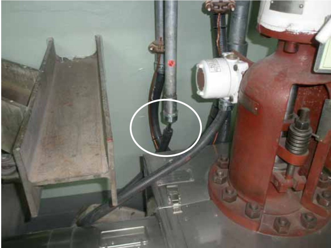
照片五 核島區 RHR A 設備室可撓性金屬接頭處脫落
