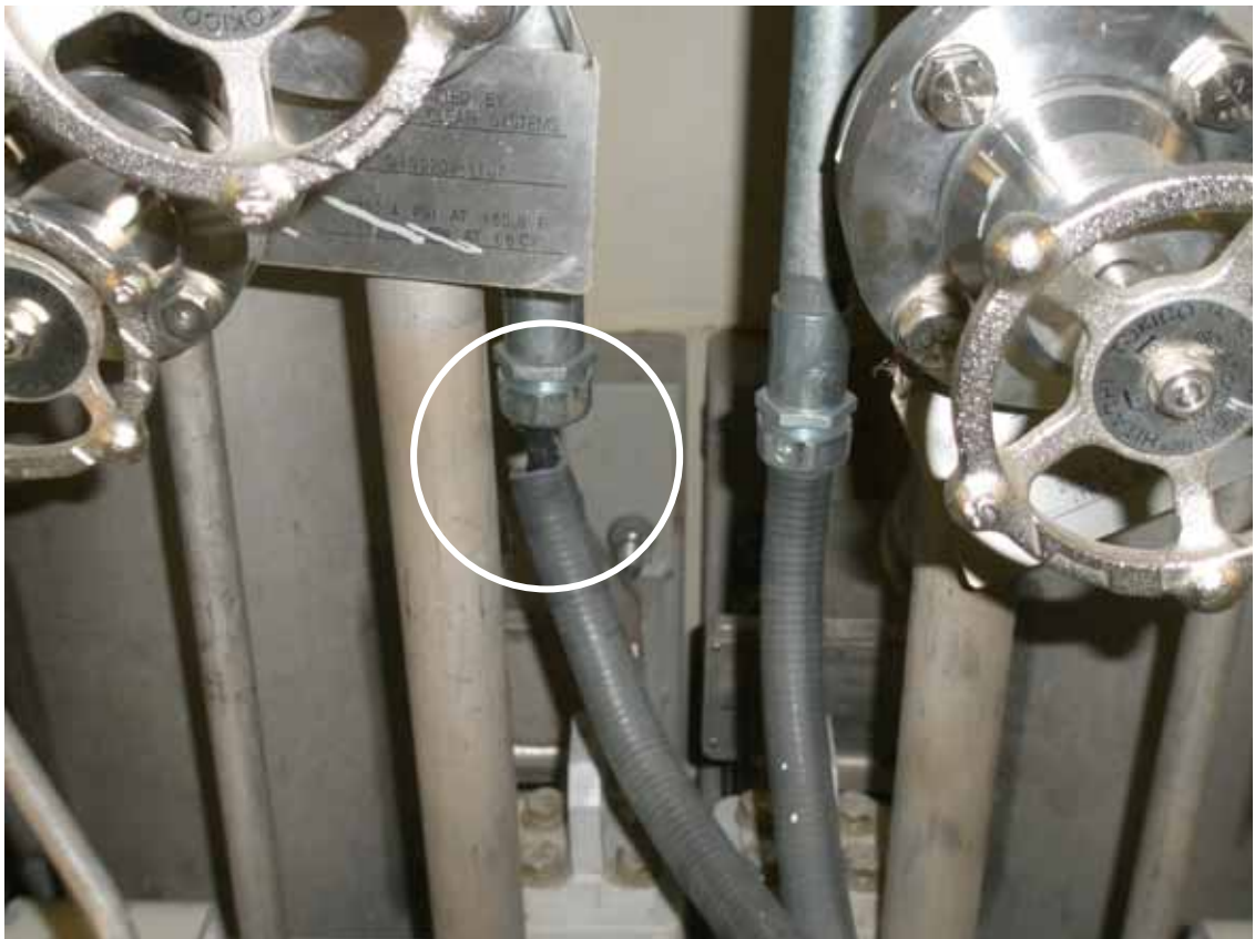
照片四 核島區可撓性金屬管接頭處脫落
