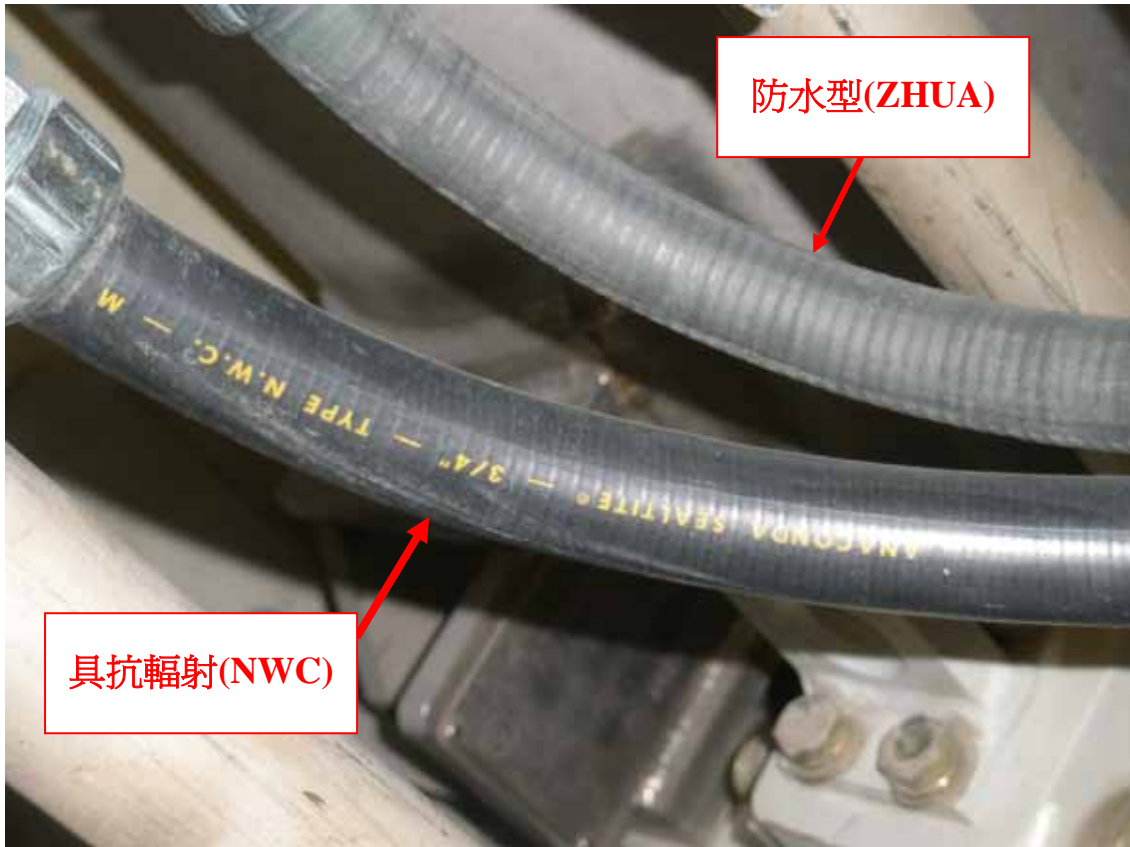
照片一 核島區 HCU 設備室可撓性金屬管使用非抗輻射型
