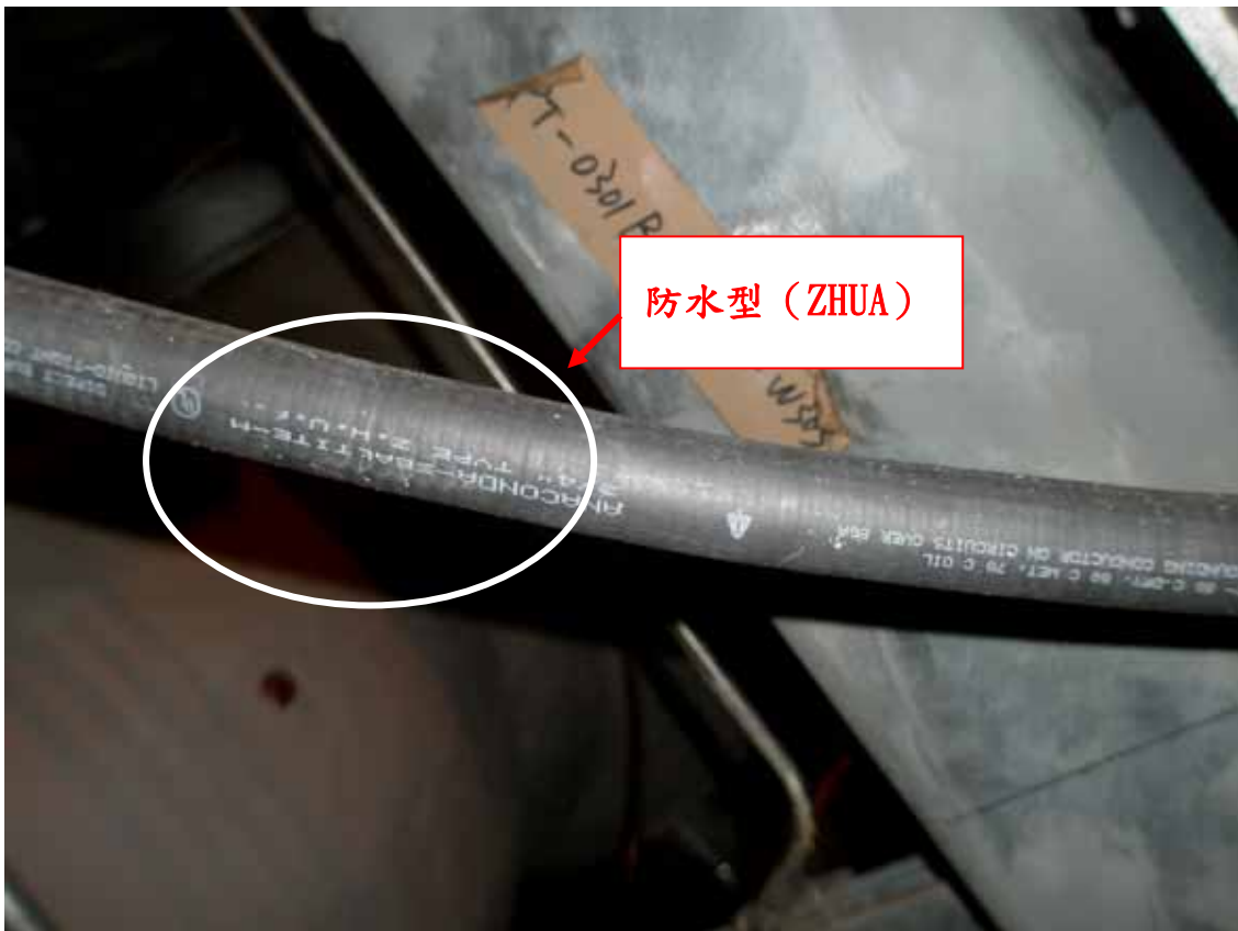
照片六 非核島區可撓性金屬管使用非抗輻射型
