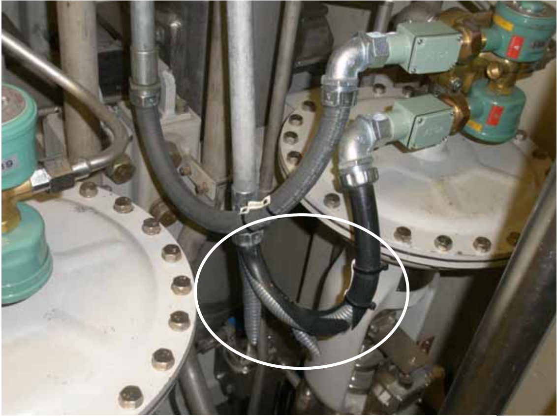
照片三 核島區 HCU 設備室可撓性金屬管外被覆剝離
