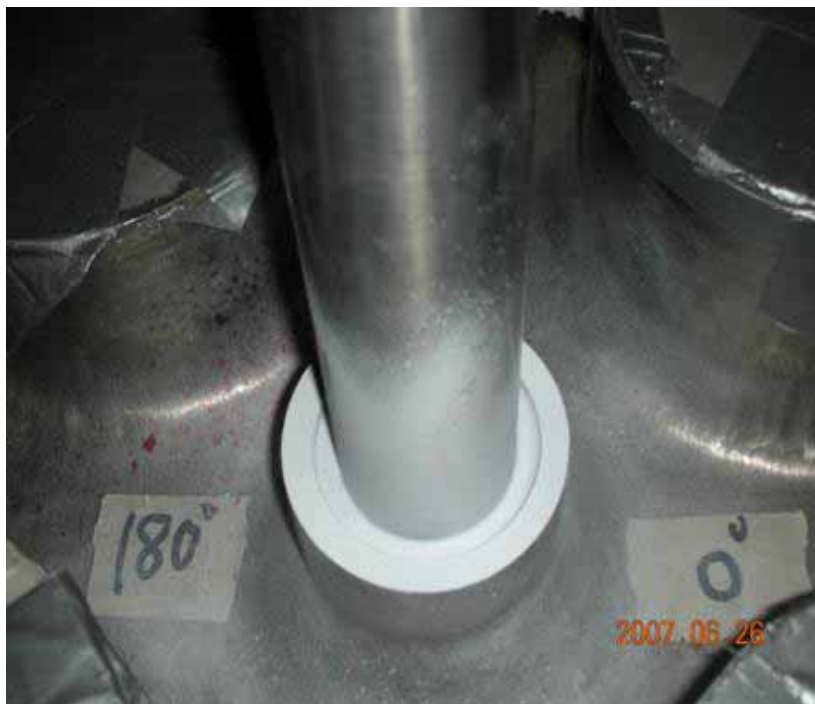
圖-20、上圖為 Incore housing 在工廠拆裝準備情形；下圖為 960626 焊接過程，正在進行階段性液滲非破壞性檢測（PLP-NDE）。
