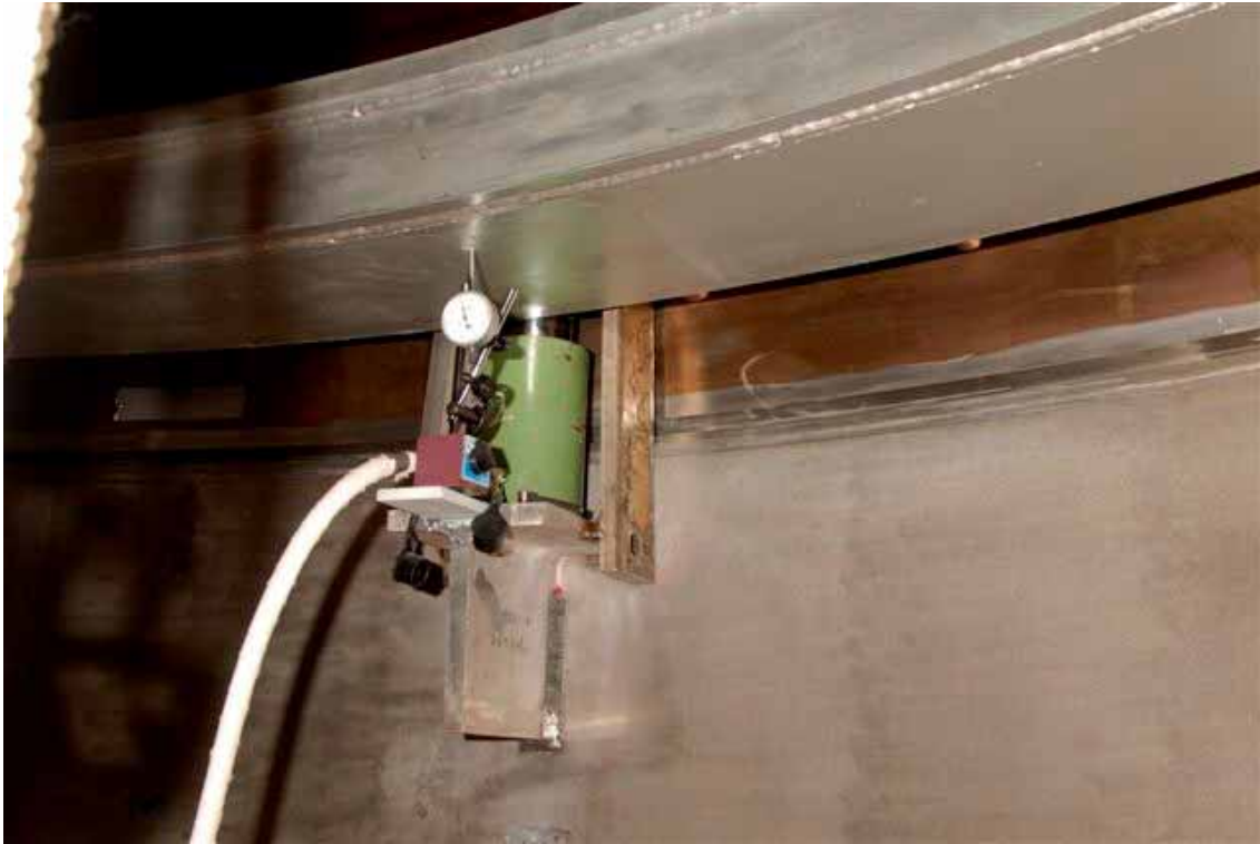
圖-2、綠色設備為 96.02.06 所見，置於 support ring 臨時支撐上的千斤頂，圖上之環狀鋼樑為 spider ring，隱於其後有 shroud 之臨時支撐。棕色部分為 shroud，其下緣之亮紋為即將供焊接之倒 J-開槽。下圖為 shroud 安裝程序書 2902-71P-2066(NE)附件 -C 的對映施工圖。
