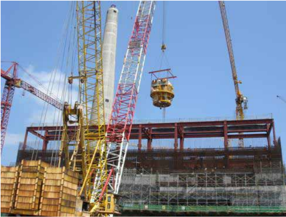
圖-11、960419 早晨將爐內組件施工之清潔管制室吊離反應器廠房之場景。背景高塔為共同煙囪。
