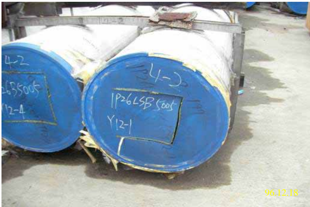
照片八：一號機 RBSW 系統管端蓋破裂情形
