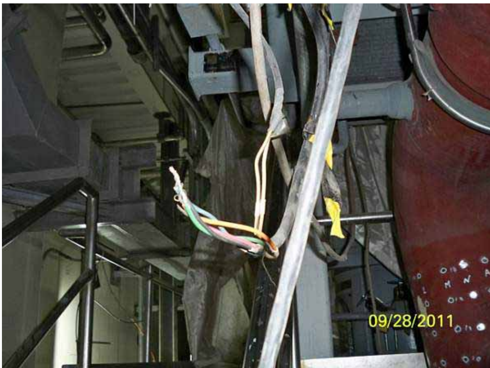
照片六 軟管及水管未固定，且電線裸露處未以絕緣膠帶包覆
