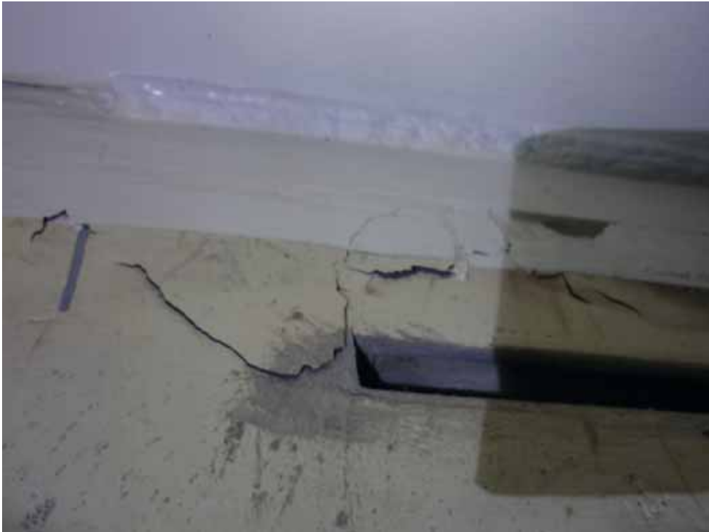
照片五 混凝土牆面損壞情形
