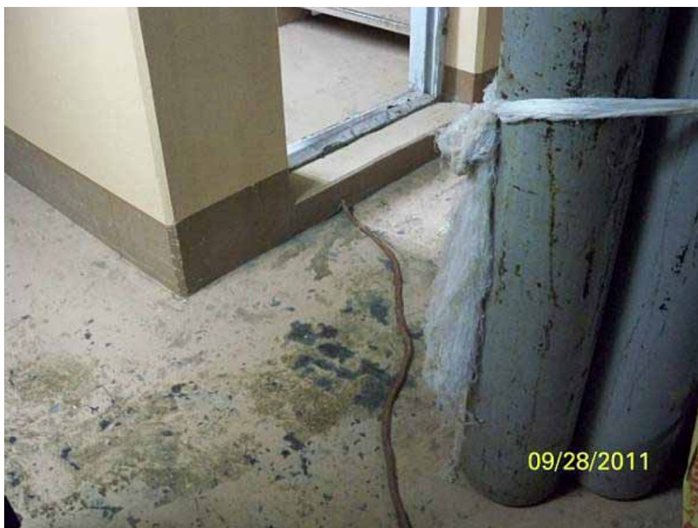
照片二 地面接地裸銅線未使用線夾整齊固定
