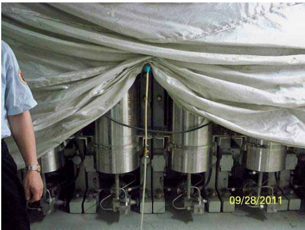
照片四 現場設備未完全被防塵套覆蓋
