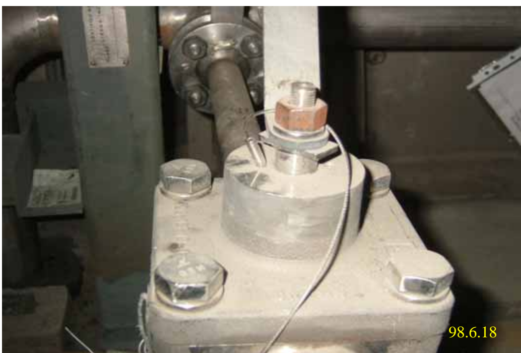
照片六：一號機迴轉攔污柵垃圾槽沖洗管路隔離閥定位銷彎曲情形
