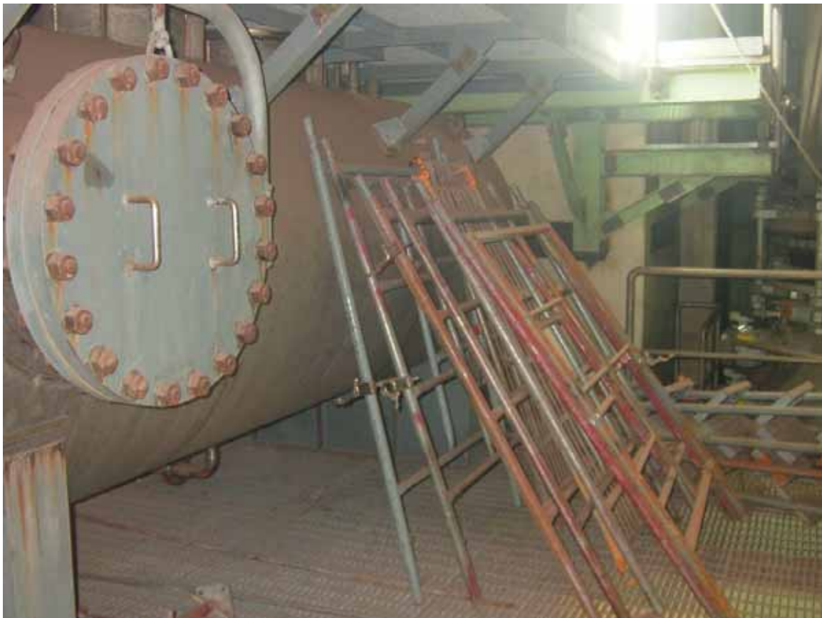
照片四 汽機廠房施工架靠在設備上，不符合程序書之要求
