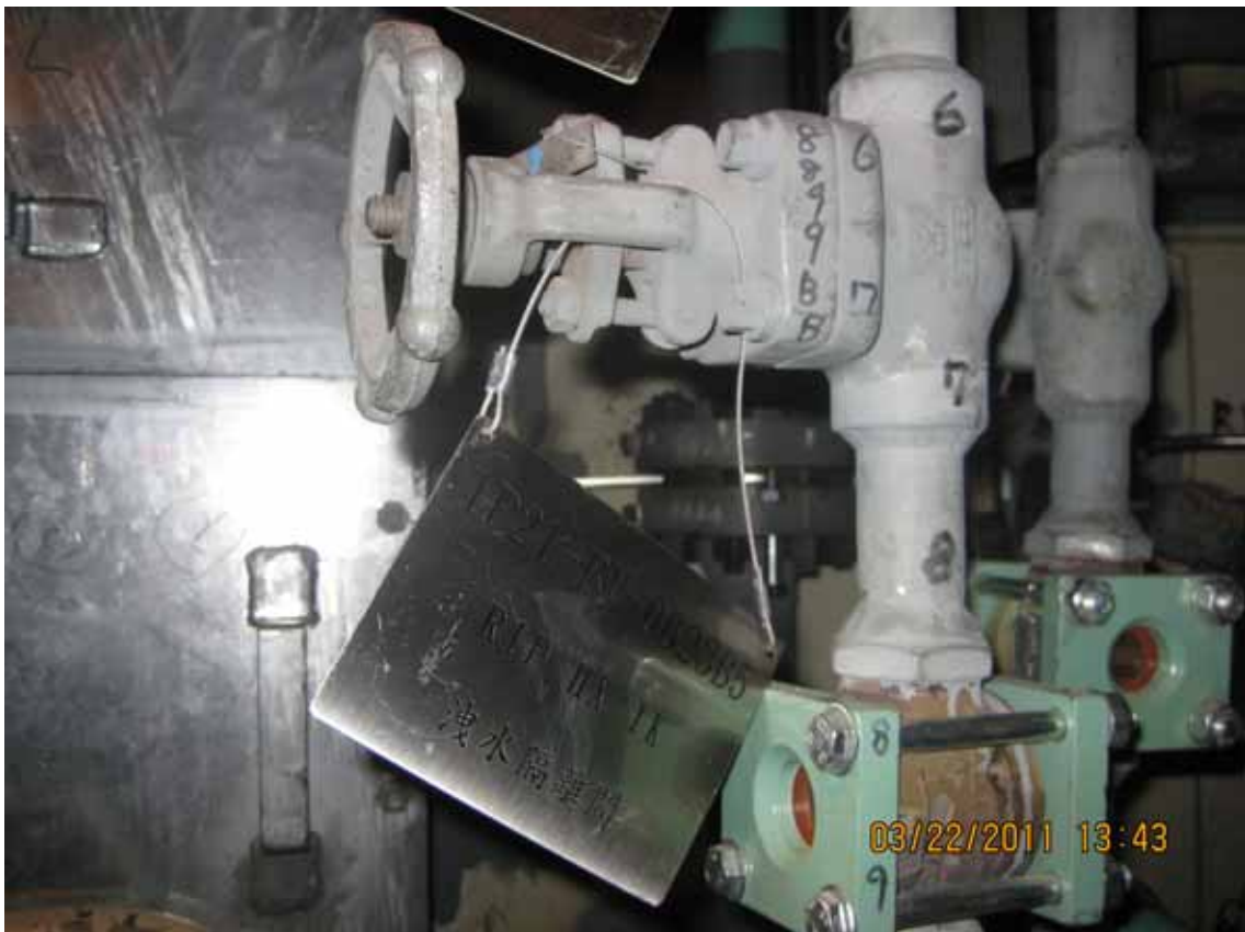
照片三 一次圍阻體內閥體及閥桿不當塗漆
