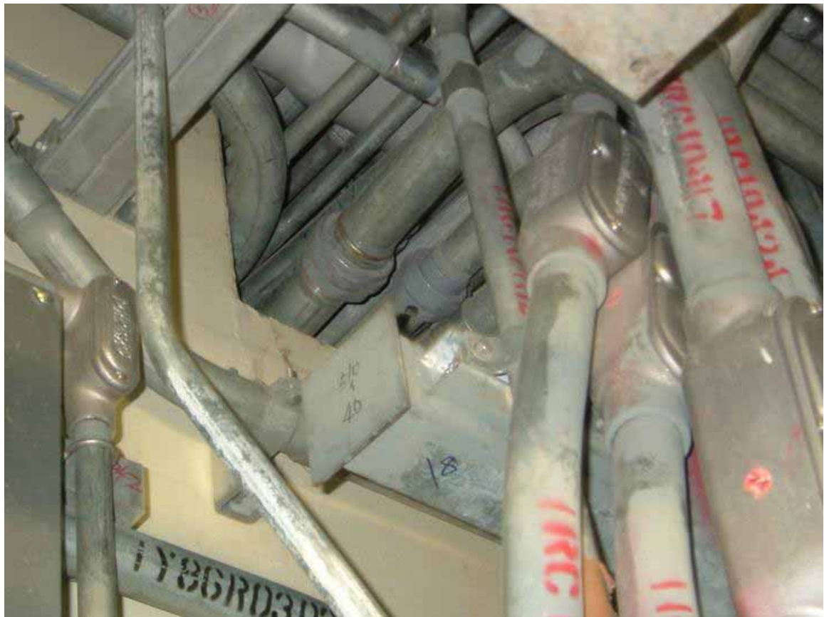
照片六 部分穿牆孔管路相當壅塞，現場不易施工
