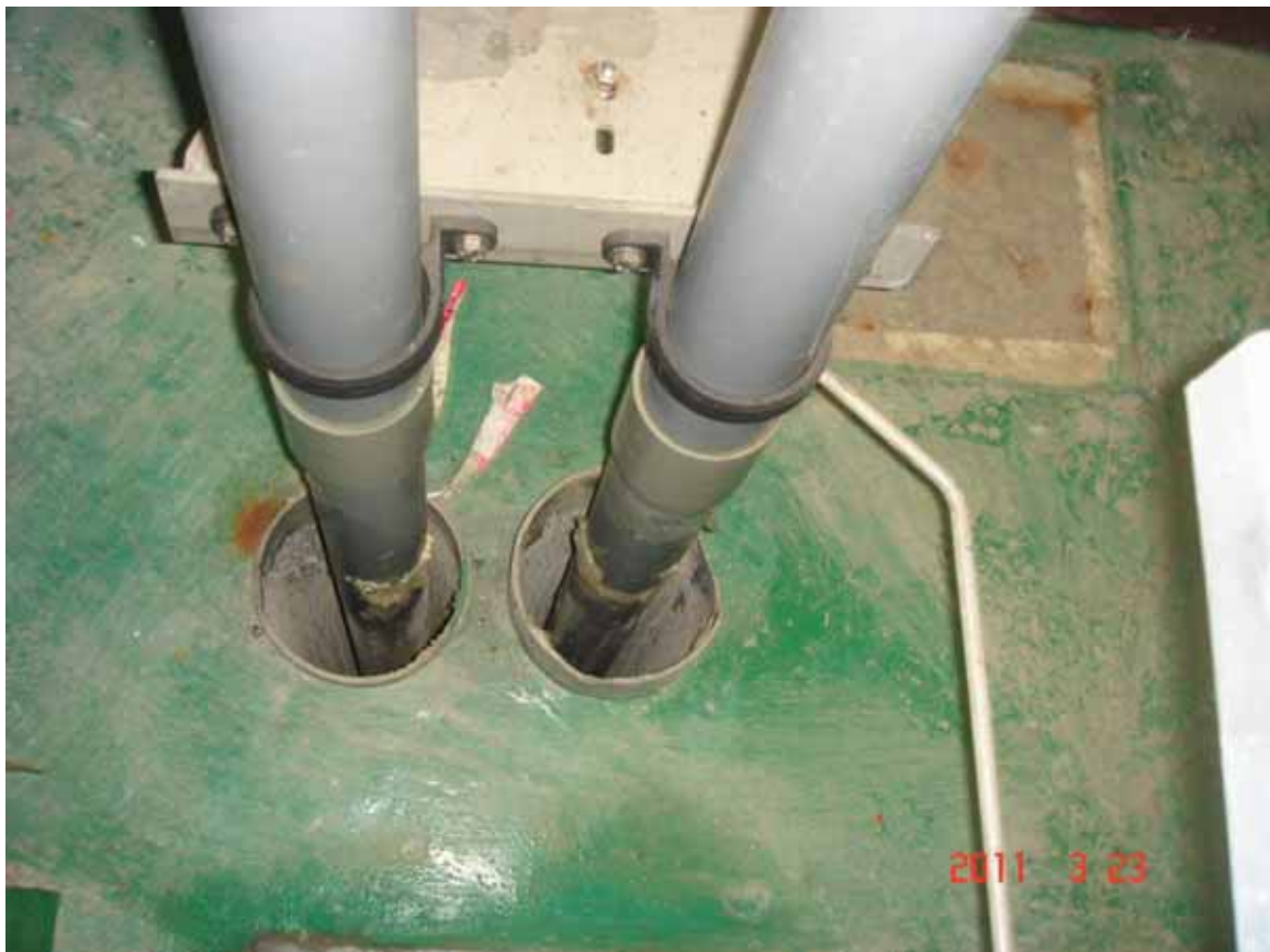
照片五 海水泵室穿越管開口未填塞密封材
