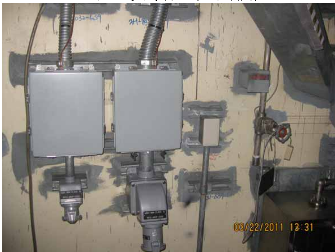
照片二 一次圍阻體內支架銲接後經修補過之塗漆凌亂，施工人員是否具有資格檢定且依據程序書執行修補作業，請澄清改善
