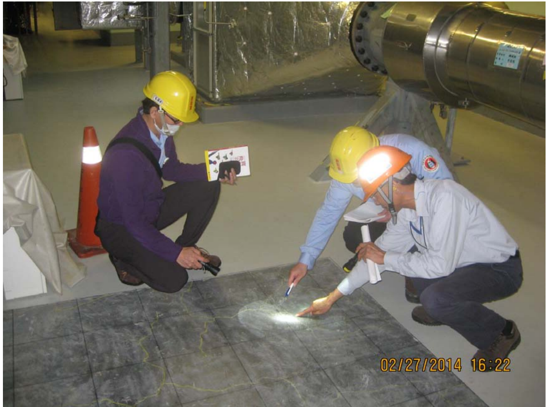
照片 7：SIT 測試加壓中原能會視察員現場目視檢查 (混凝土裂縫 Mapping)
