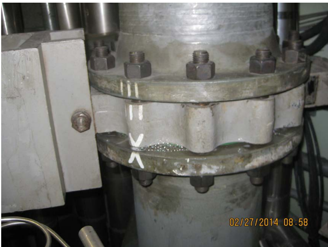
照片 6：SIT 測試加壓中現場目視檢查發現洩漏處 (1T31 ACS ABV-0032 內側過壓保護隔離閥)
