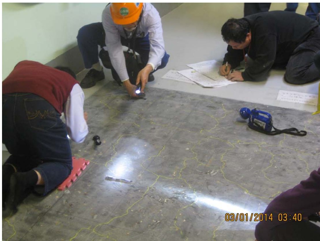
照片 9：SIT 測試最大壓力持壓期間之混凝土裂縫 Mapping 現場檢查與記錄作業情形
