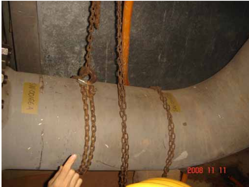
HPCF 管路塗有防銹油漆，造成管路廠製銲道不易查證
