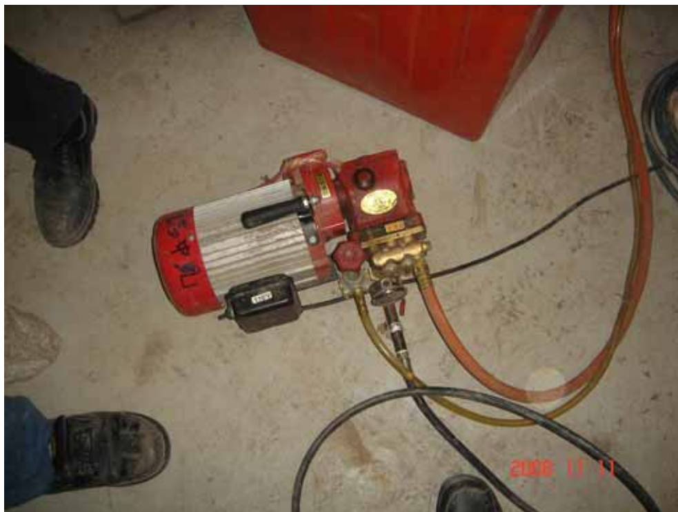
使用於 HPCF 管路水壓測試的加壓泵
