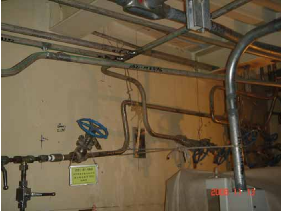
廠房不銹鋼管路纏繞及吊掛鐵絲的情形
