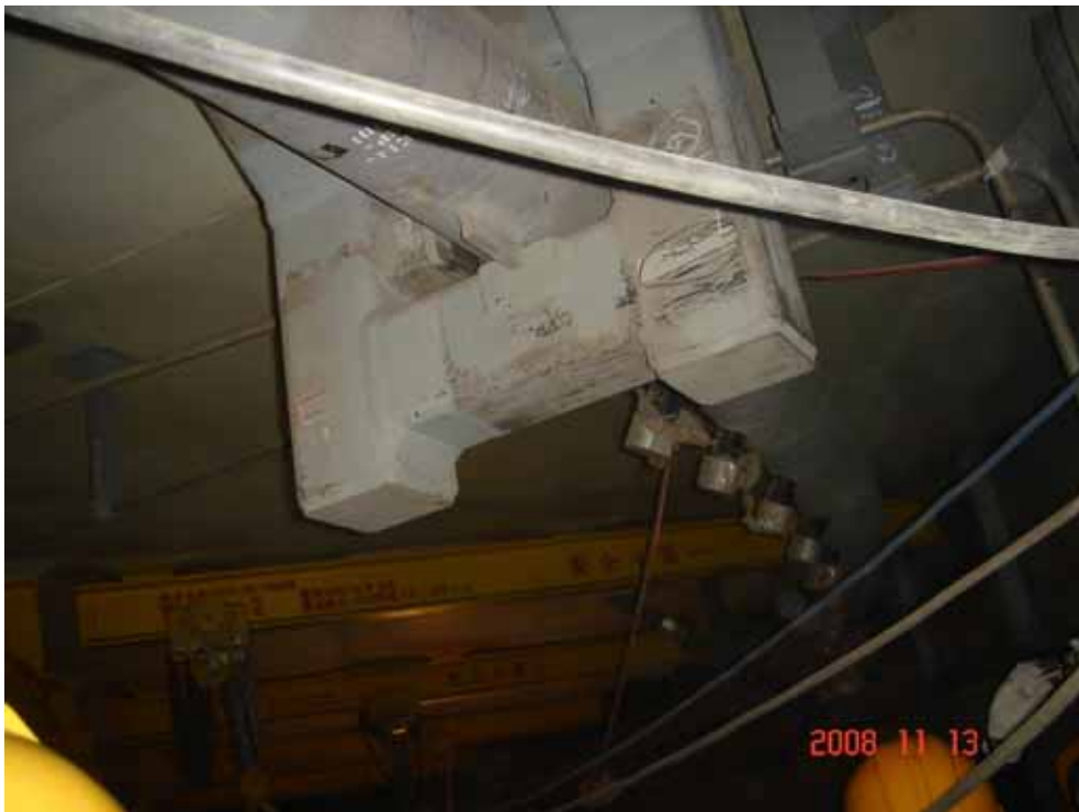
不銹鋼管與碳鋼支架直接接觸
