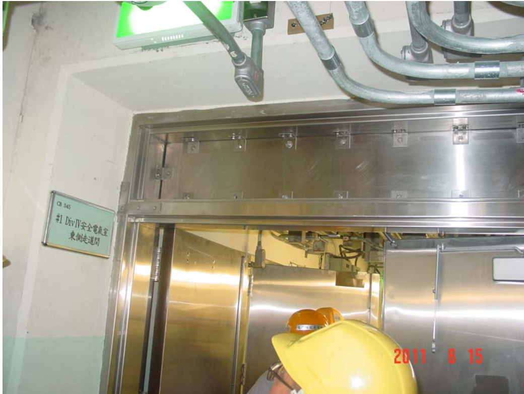
CB 311 電氣室走道間以不鏽鋼板當 3 小時防火屏障，不符要求
