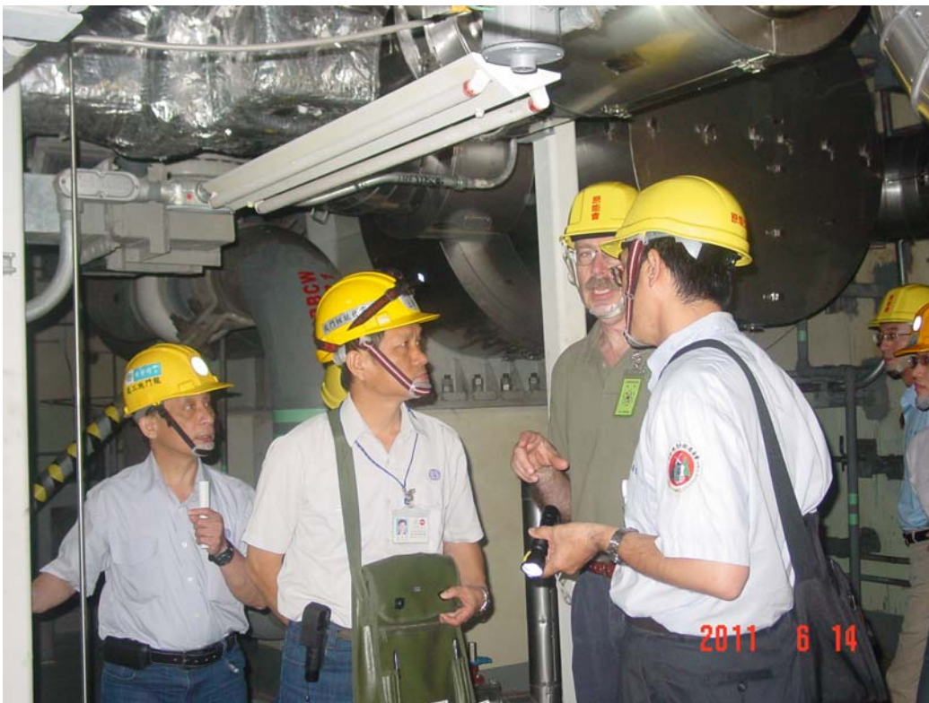
本會視察員與 NRC 專家巡視 RHR A 泵室設備
