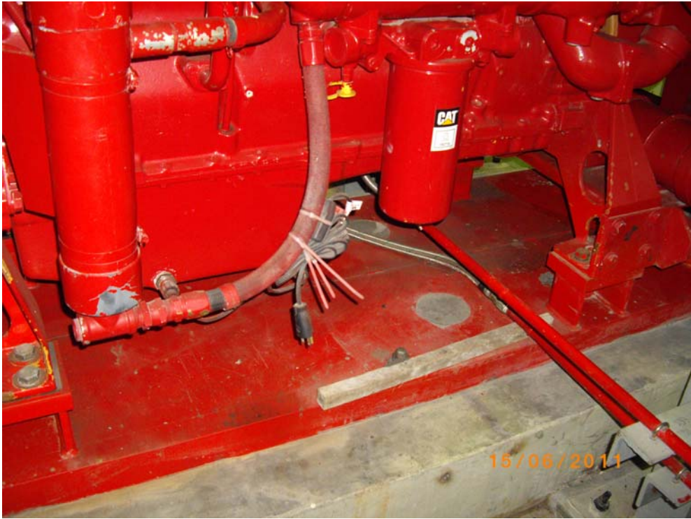
耐震 I 級消防泵上有外接之電氣設備插頭
