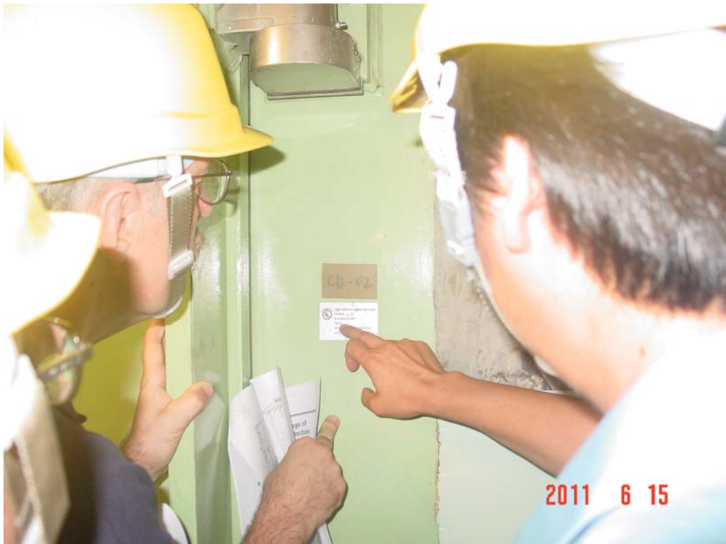
耐火 3 小時防火門標籤為貼紙型式，非 UL 提供及認證之合格標籤
