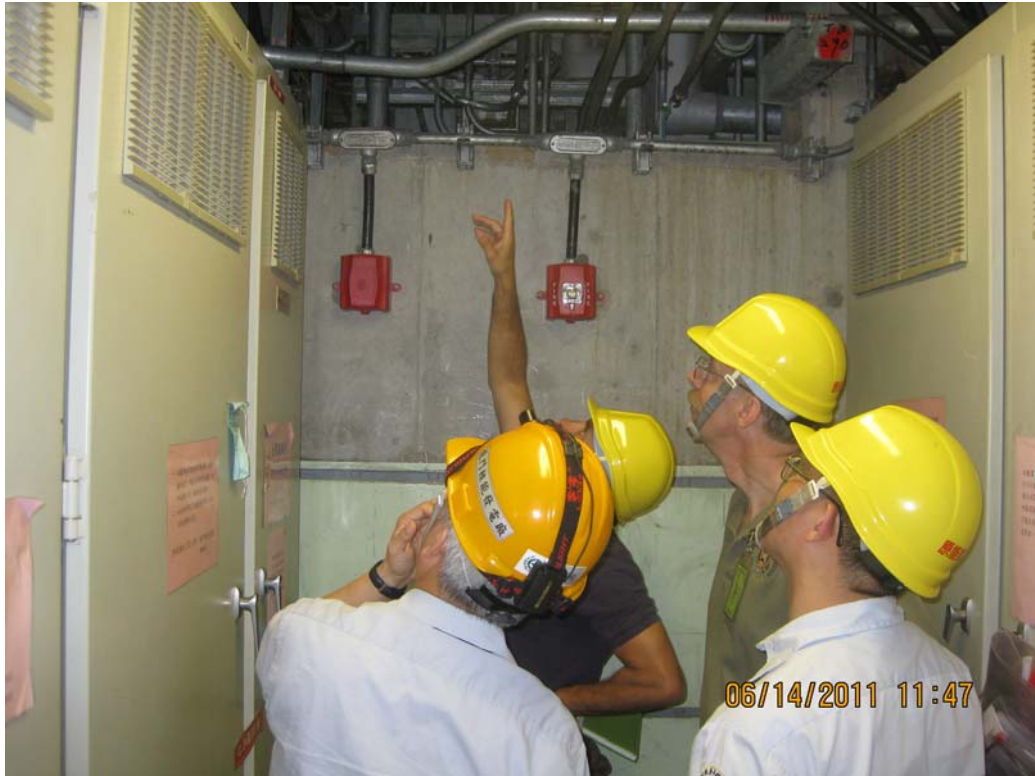
在 RB EL. 4800 檢查 RMU 室與安全電氣室間電氣實體隔離情形
