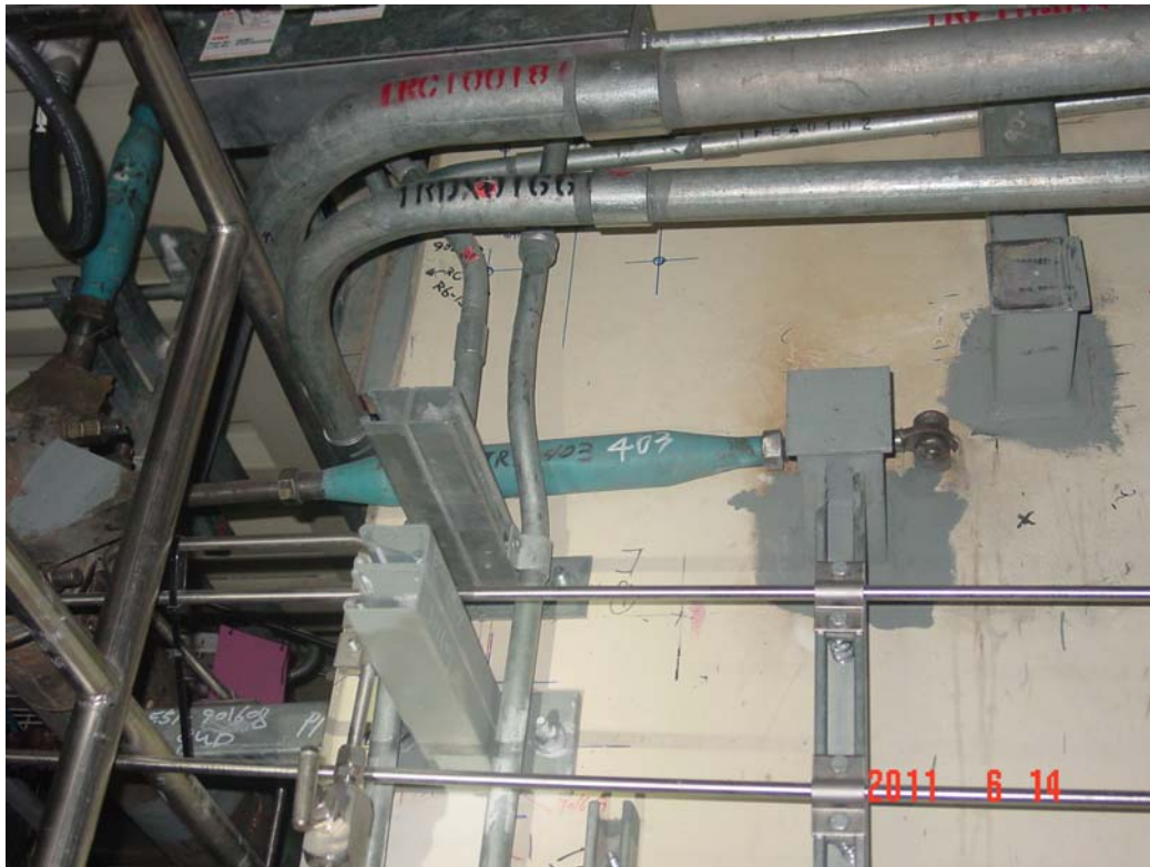
RCIC 管路支架 Strut 1E51-STRT-0403 與牆壁間隙疑似不足
