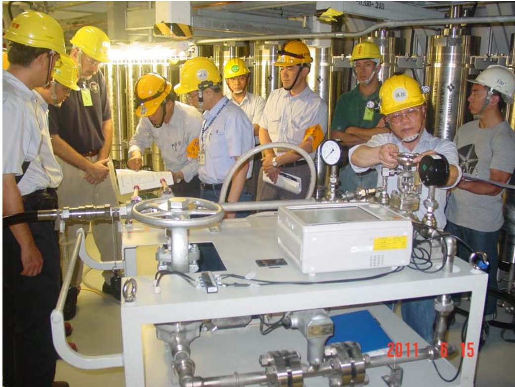
本會視察員與 NRC 專家對照程序書視察控制棒摩擦測試進行
