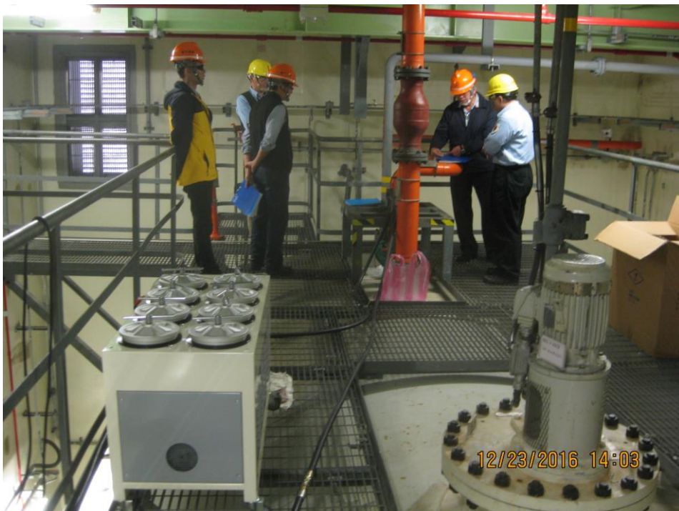
照片 2:SDG 貯油槽室內查證濾油作業
