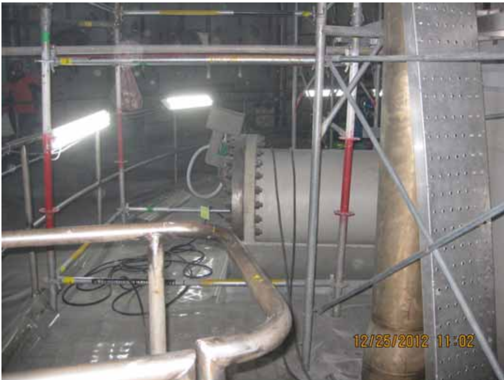
照片 8：電銲作業下方真空破壞閥未加防護
