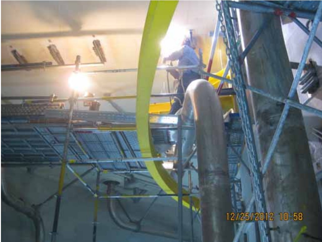
照片 7：電銲作業防火布鋪設並不完整
