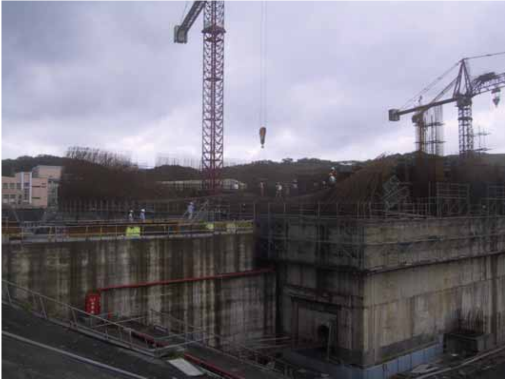
照片五、一號機汽機廠房東側鋼筋傾倒情形(一)
