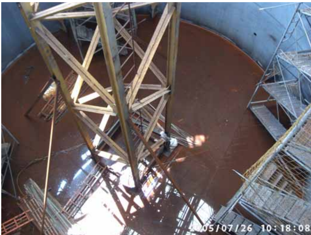
照片八、二號機反應器廠房乾井積水情形
