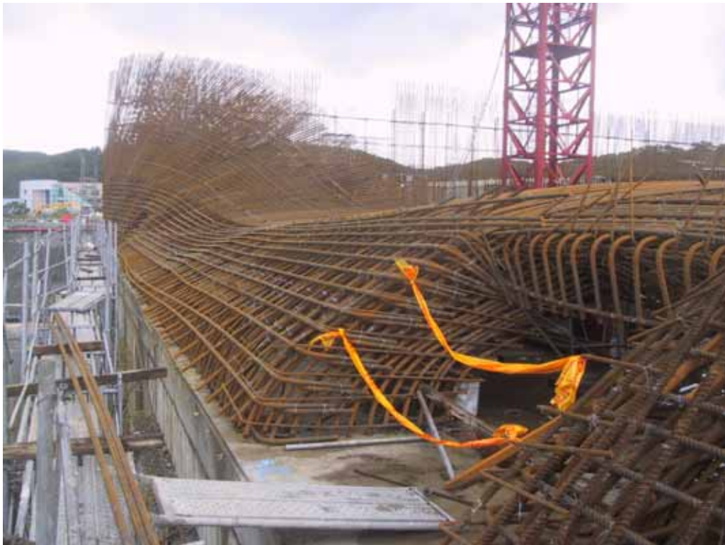
照片六、一號機汽機廠房東側鋼筋傾倒情形(二)
