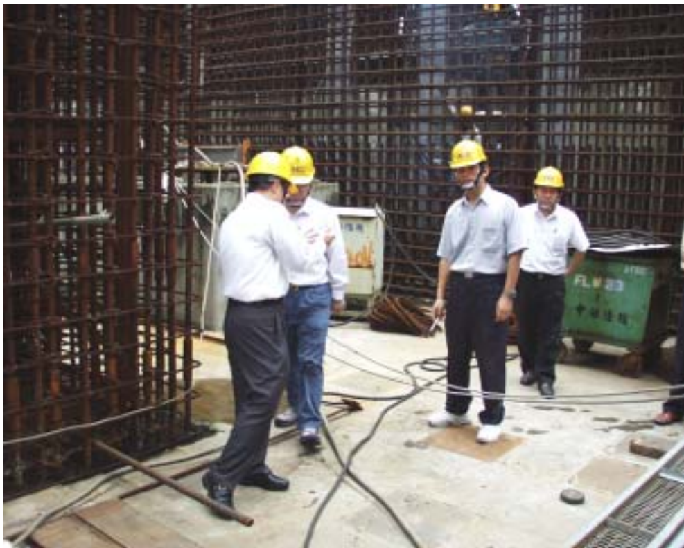
圖四：工地電源任意拉線情形
