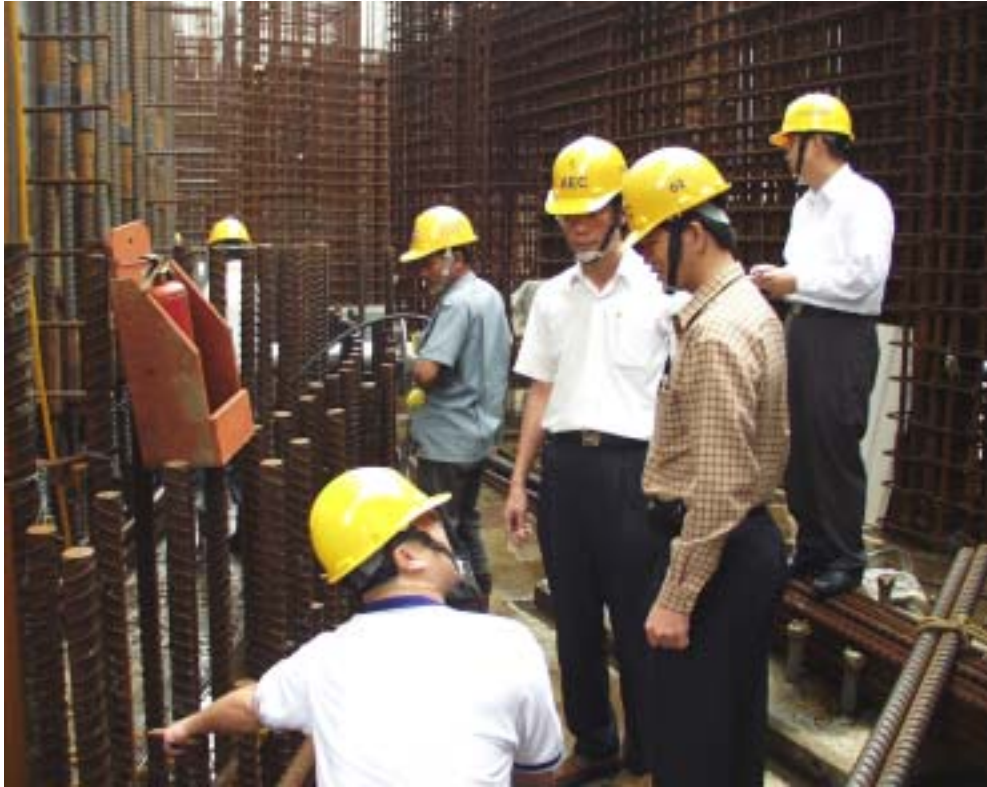
圖五：視察反應器廠房 RCCV WALL 下方積水情形
