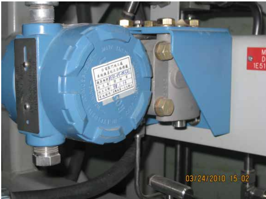
照片五 校正標籤有效期未更新
