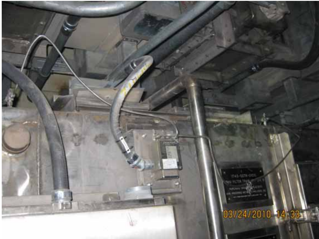
照片一 Sensing line 管路彎曲
