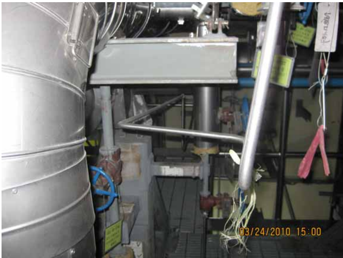
照片四 Sensing line 未加裝 support
