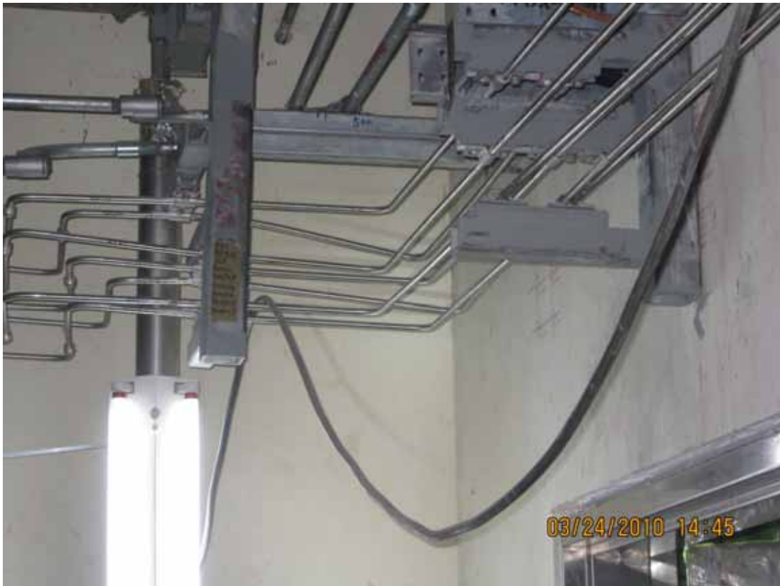
照片二 Sensing line 管路傾斜
