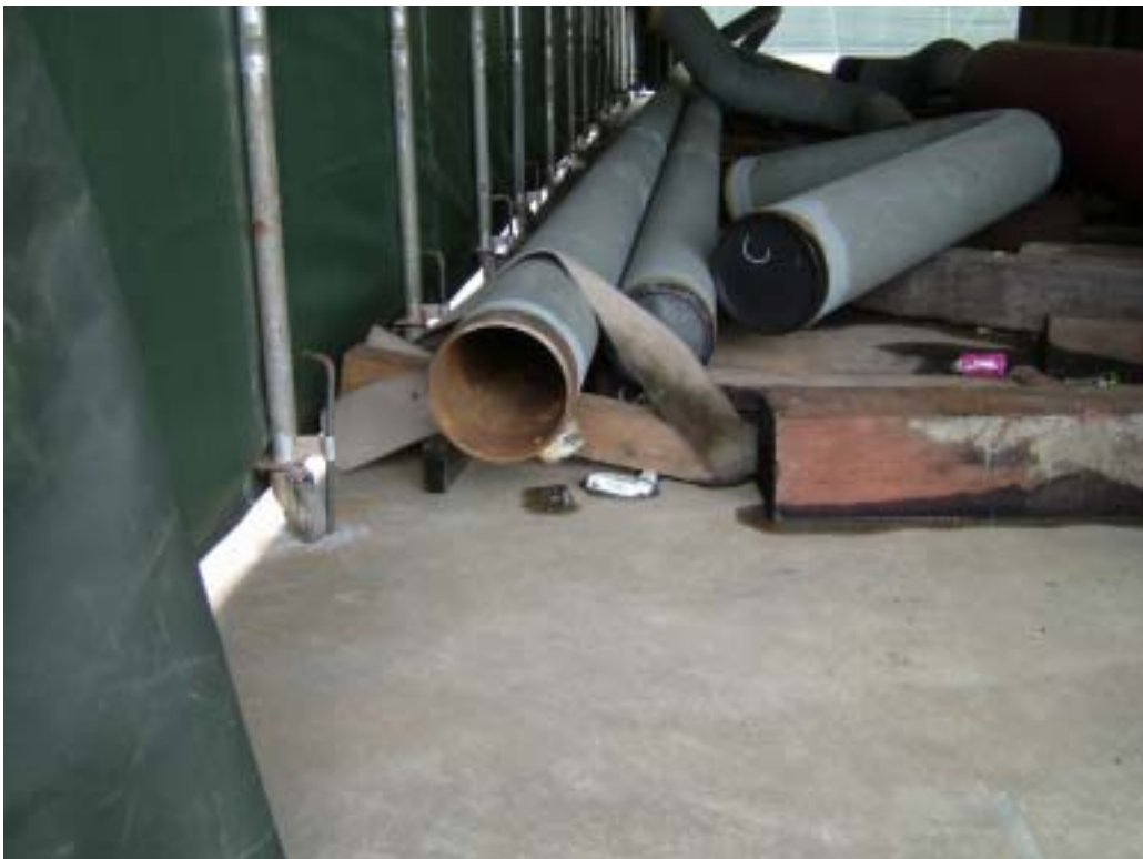
照片十：管節封蓋脫落情形
