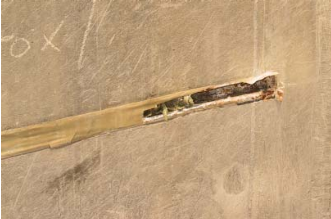
照片十一：反應器廠房預埋鐵件-線槽內部鏽蝕之情形
