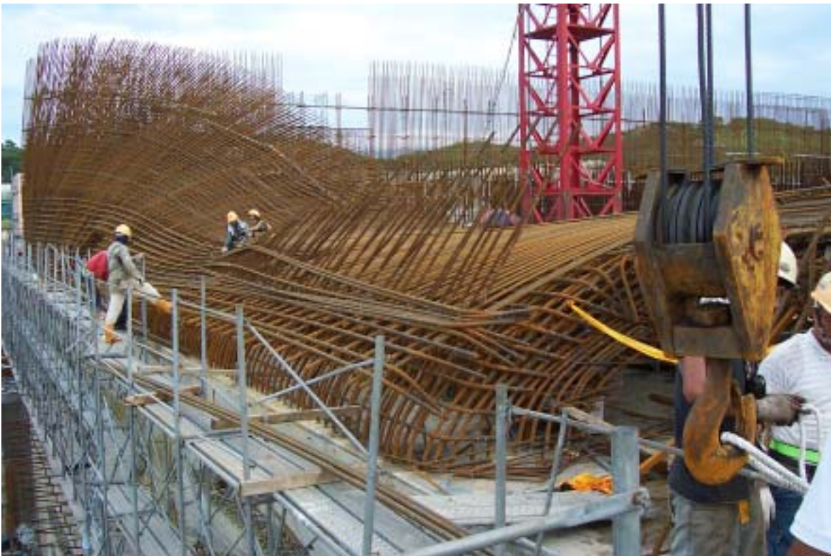
圖八：海棠颱風致一號機汽機廠房東側外牆鋼筋倒塌受損狀況
