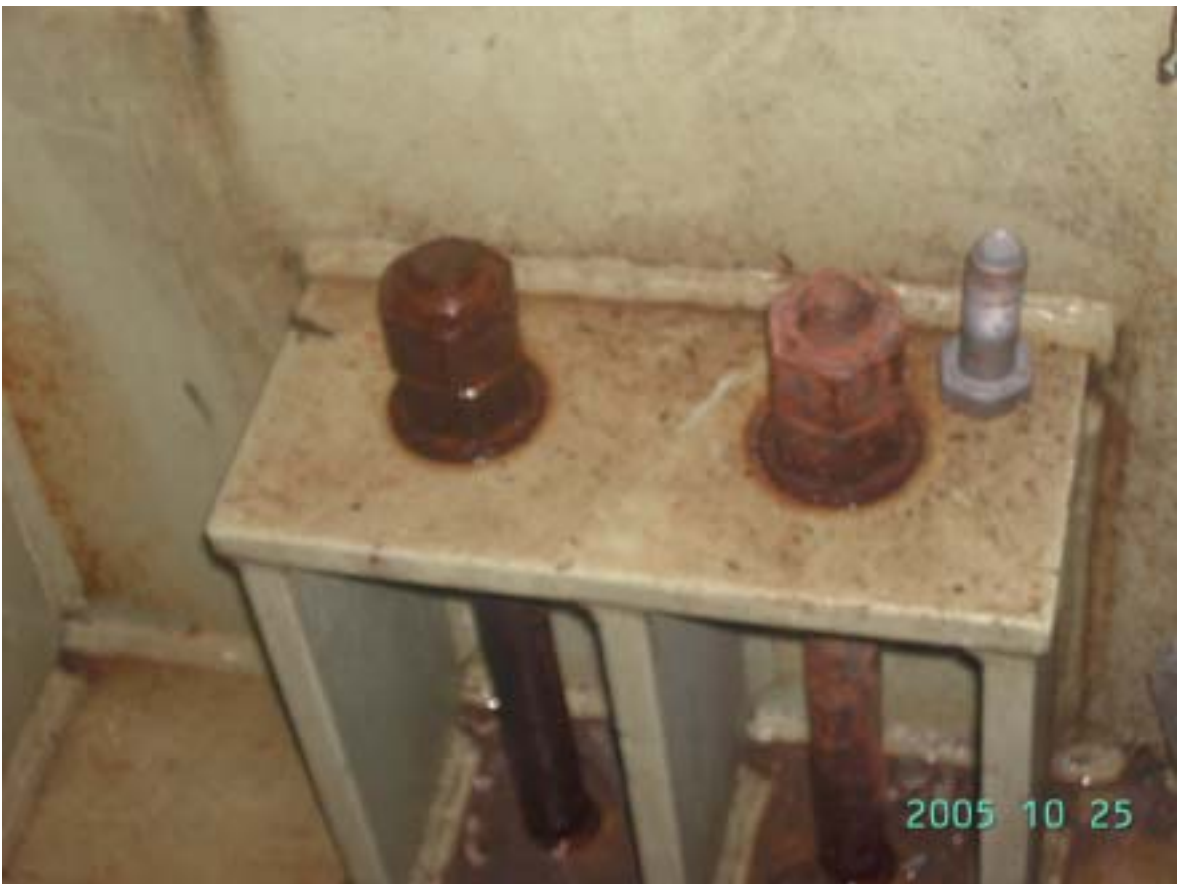
圖六：A307 錨定螺栓使用二顆螺帽安裝現況
