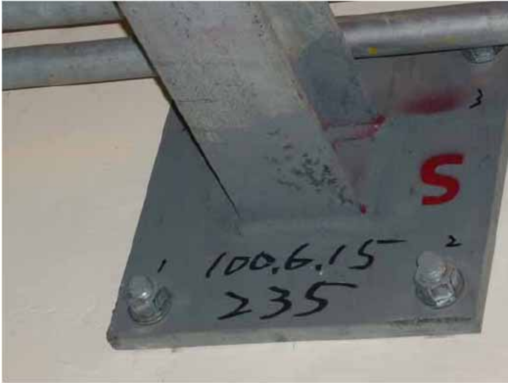
照片 7：RBSWPH 泵室 SMP 螺栓遭截切情形
