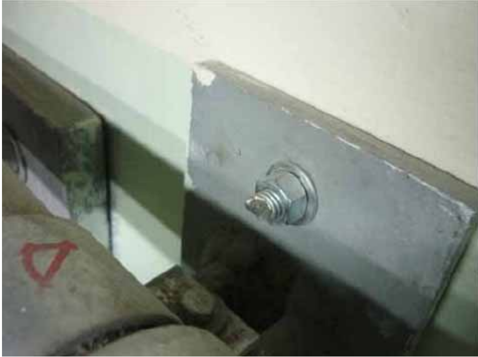
照片 9：一號機 RB 433 房間安全級導線管支架 SMP 螺栓遭截切
