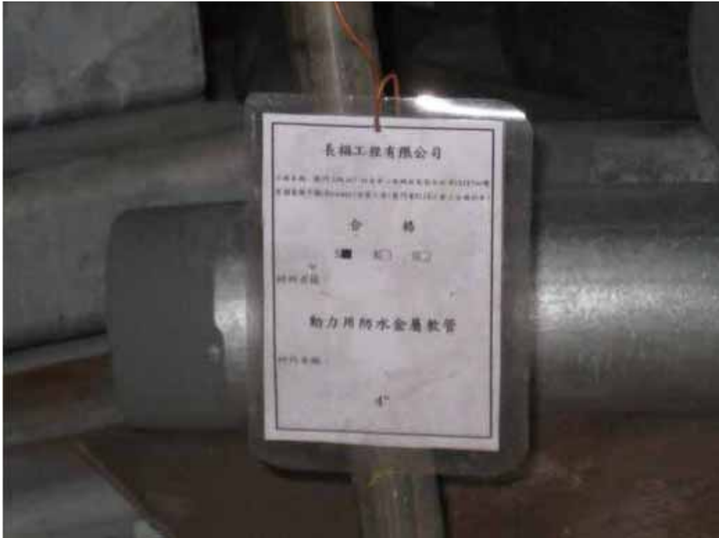
照片 3：安全級承包商儲存區域內標識錯誤
