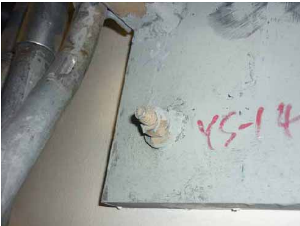
照片 12：螺栓墊片遭點銲之情形
