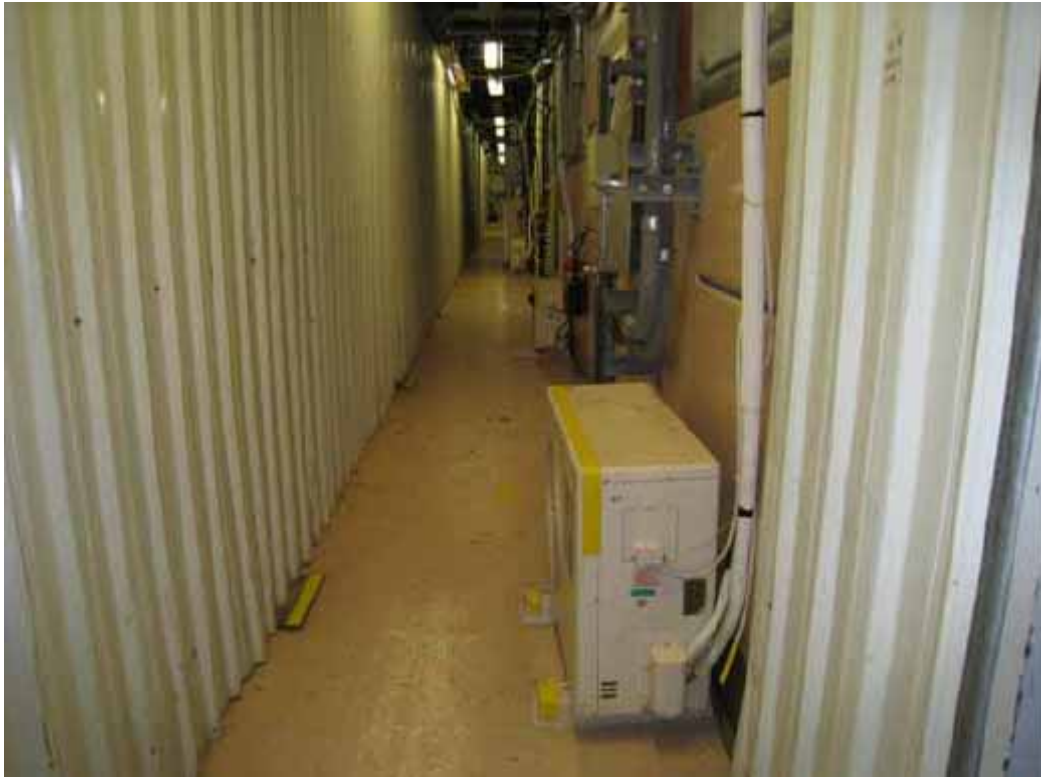
照片 5：二號機 SGB 空調室外機仍裝於廠房內
