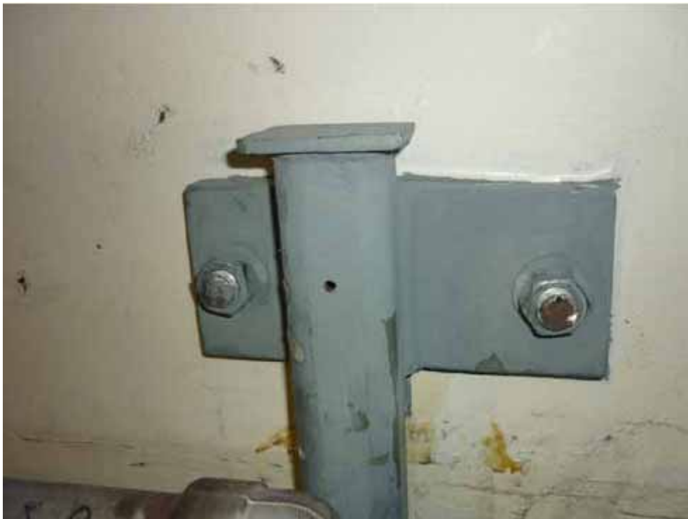
照片 10：一號機 RB 447 房間 1P52-GUD-802392 支架 SMP 螺栓遭截切
