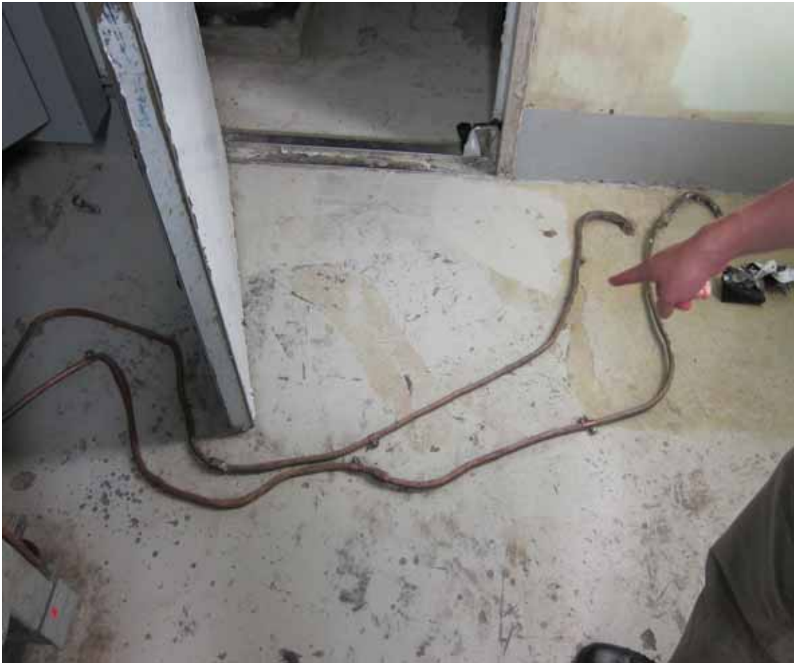
照片三 緊急柴油發電機設備接地線過長橫跨走道有安全疑慮問題
