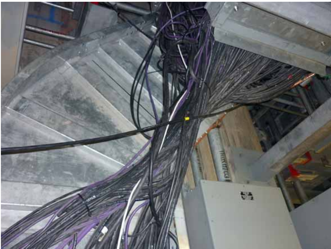
照片二 1號機反應器廠房 cable tray 轉彎處纜線雜亂
