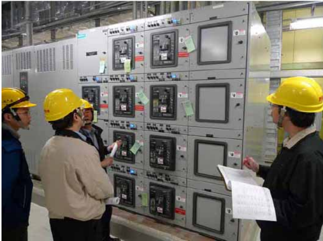
圖四 因應事故以移動式 480V 發電機接入電源之開關箱
