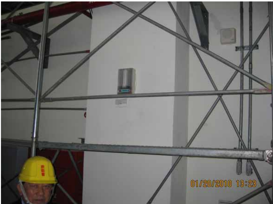
照片 2 開關場部分緊急照明燈故障
