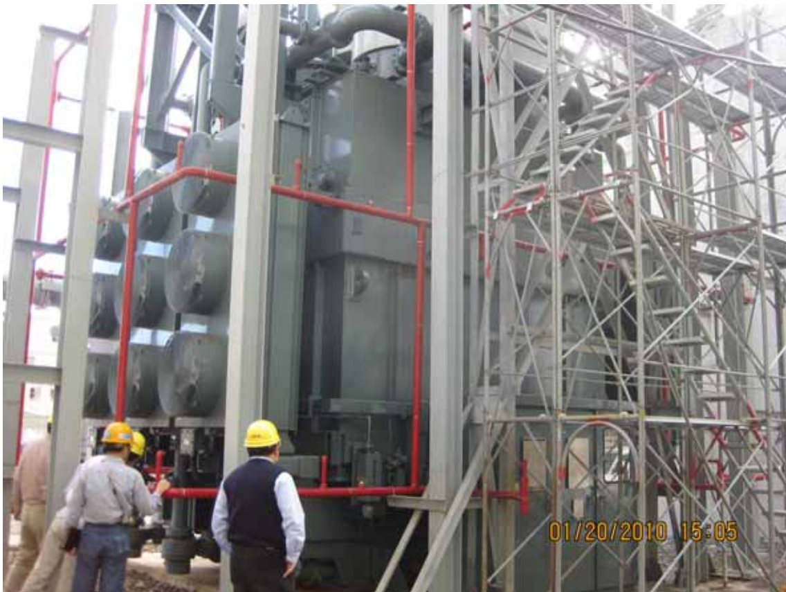
照片 6 變壓器消防管路查證
