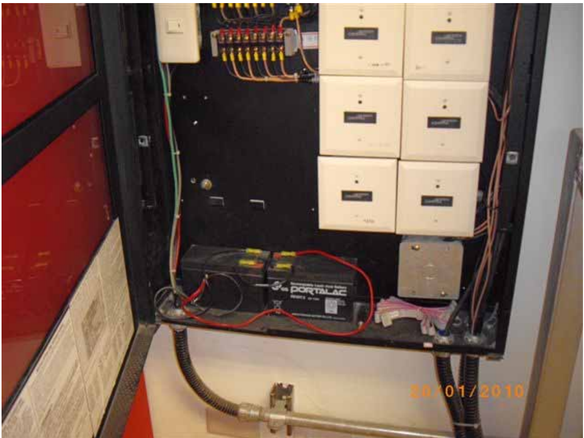
照片 4 開關場火災受信機現況
