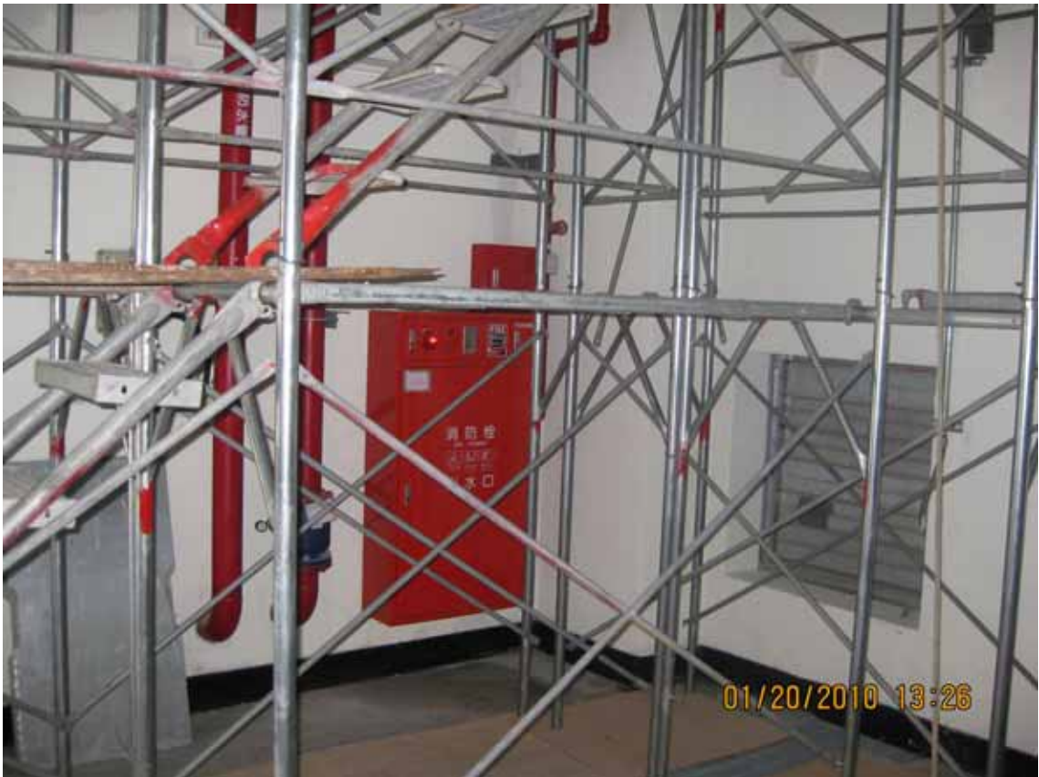
照片 3 開關場部分消防設備被搭架阻礙無法使用
