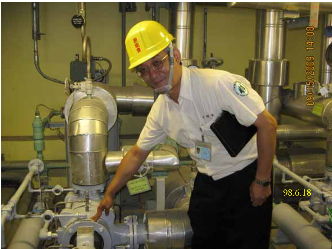
照片八：一號機輔助鍋爐廠房查證飼水泵維護保養作業
