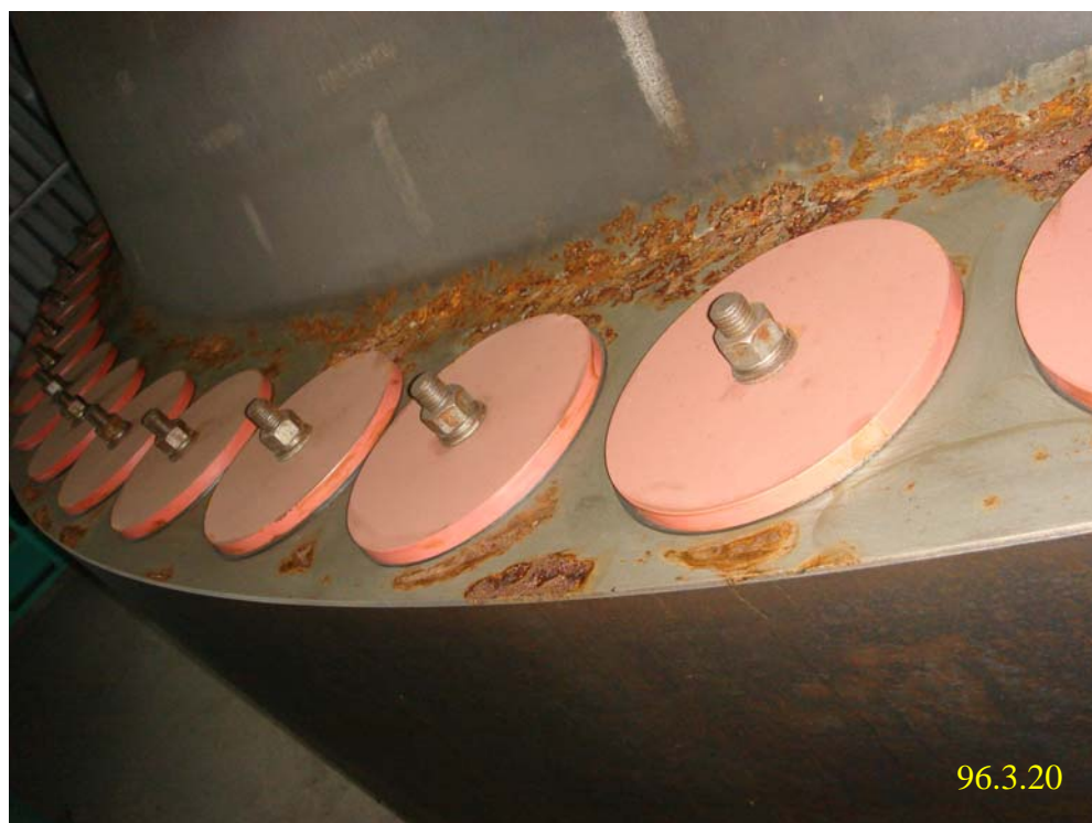
照片十二：二號機反應爐壓力槽頂蓋格蘭圓周四周鏽蝕痕跡（二）
