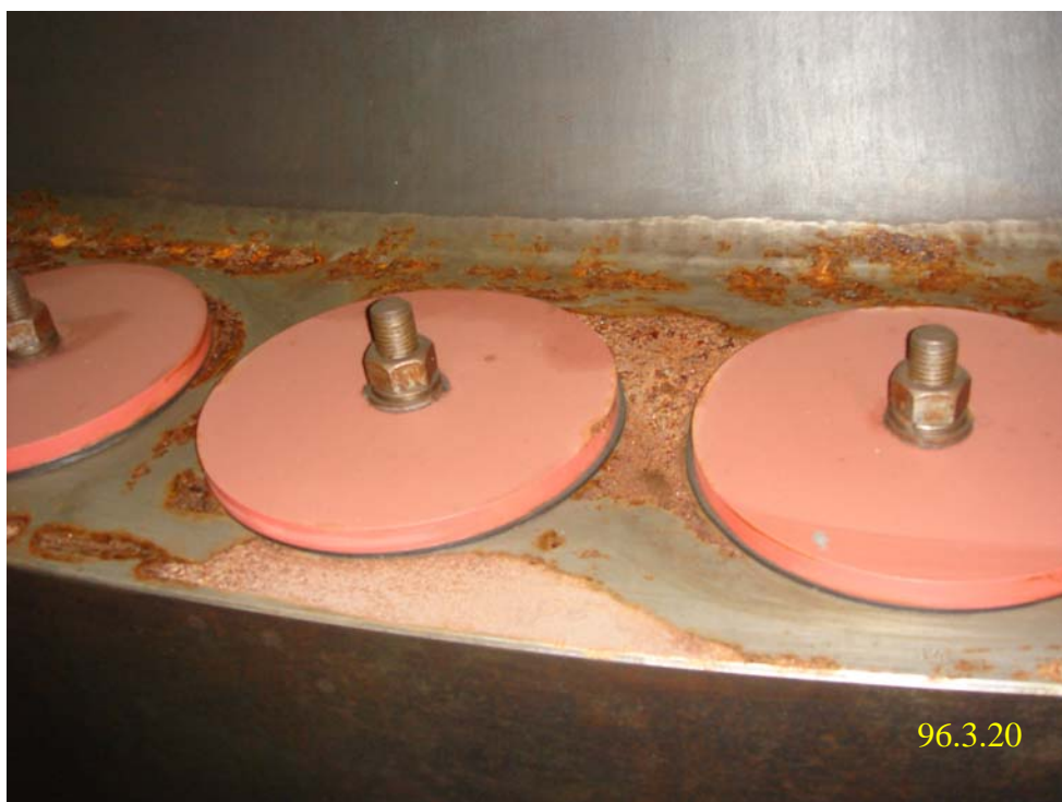
照片十一：二號機反應爐壓力槽頂蓋格蘭圓周四周鏽蝕痕跡（一）
