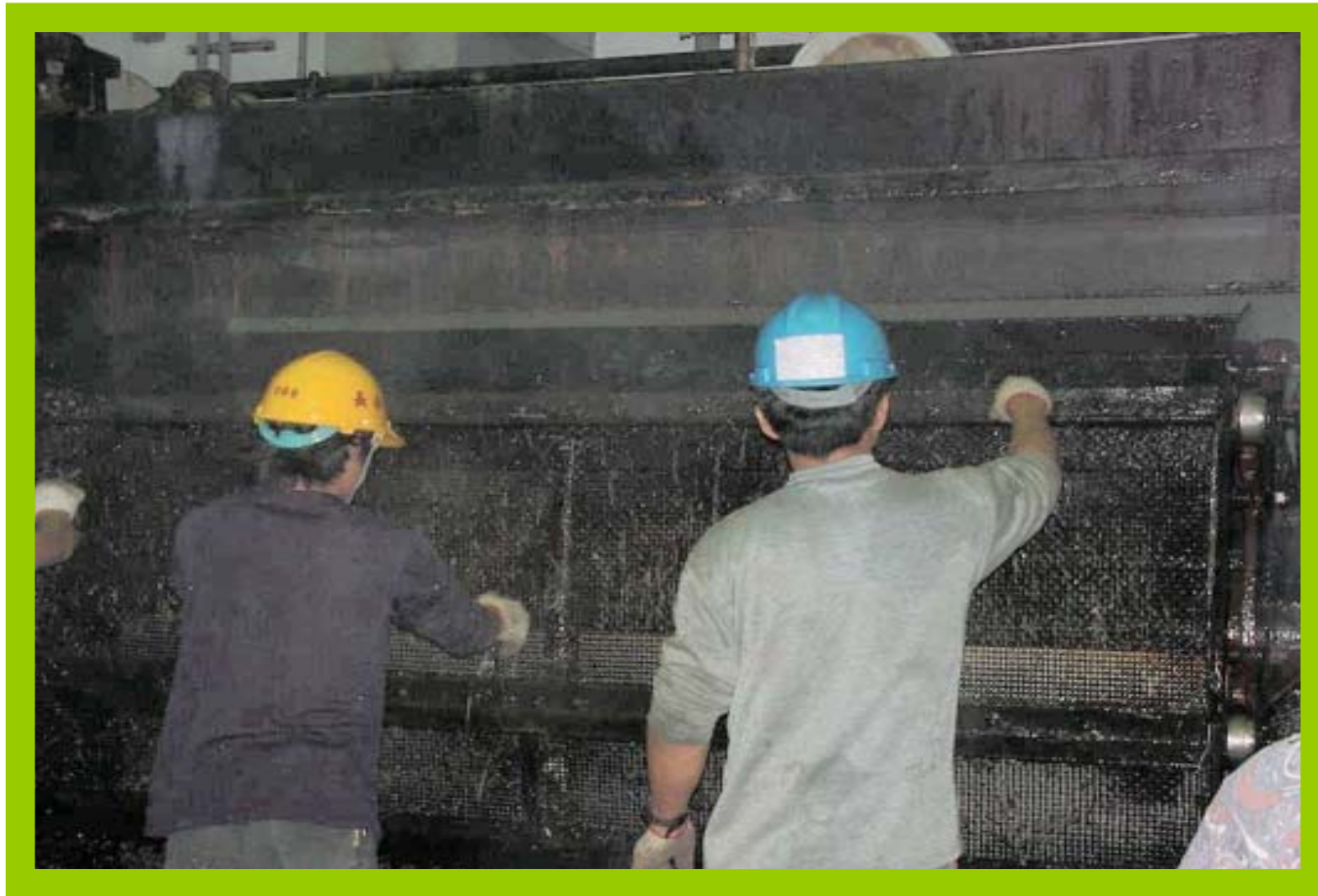
圖四、核二廠海水泵室清理迴轉攔污柵情形
