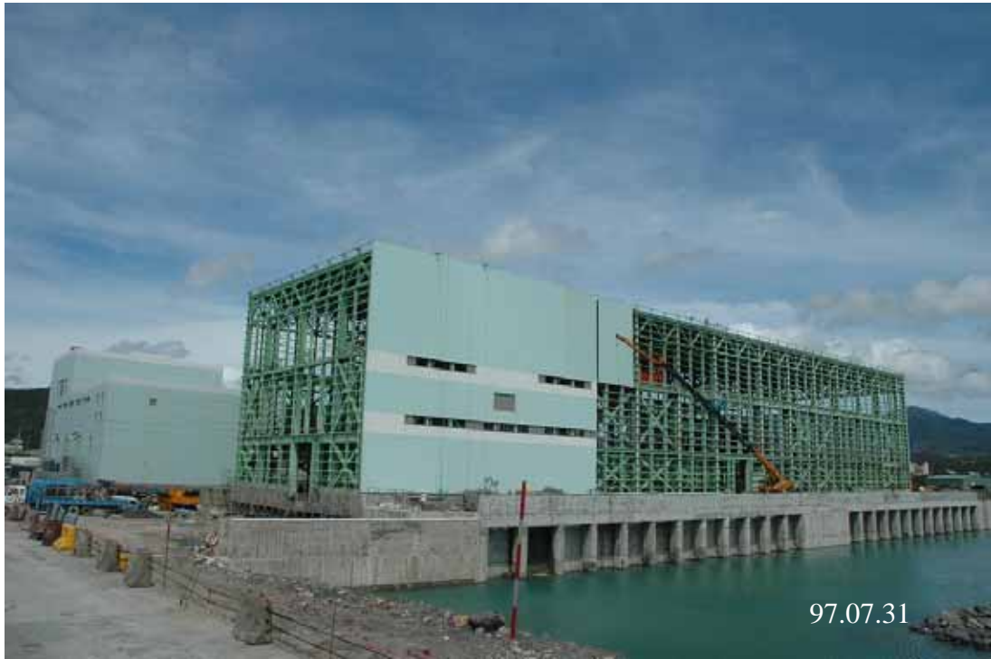
圖一：循環水抽水機房
