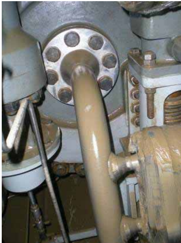
圖十二 爐心隔離冷卻水系統淹水後淤泥狀況
