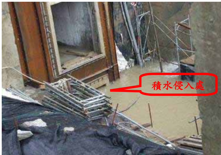
圖五 廢料隧道淹水（實際水位較照片上為高）
