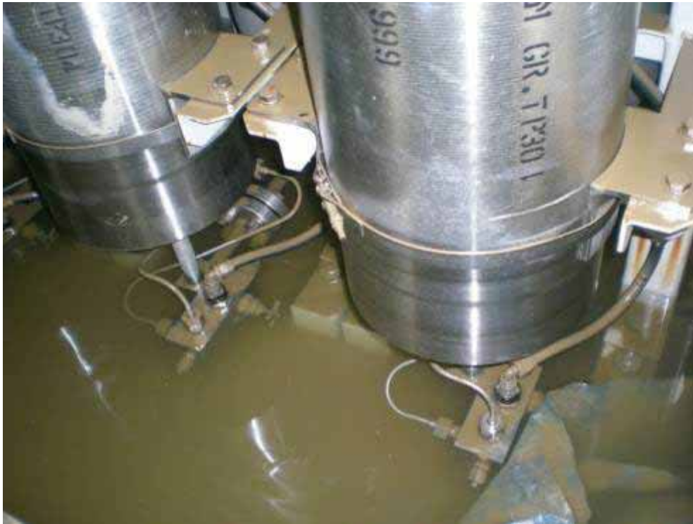
圖十一 控制棒液壓控制單元淹水狀況（水位已排至約剩 10~15 公分）
