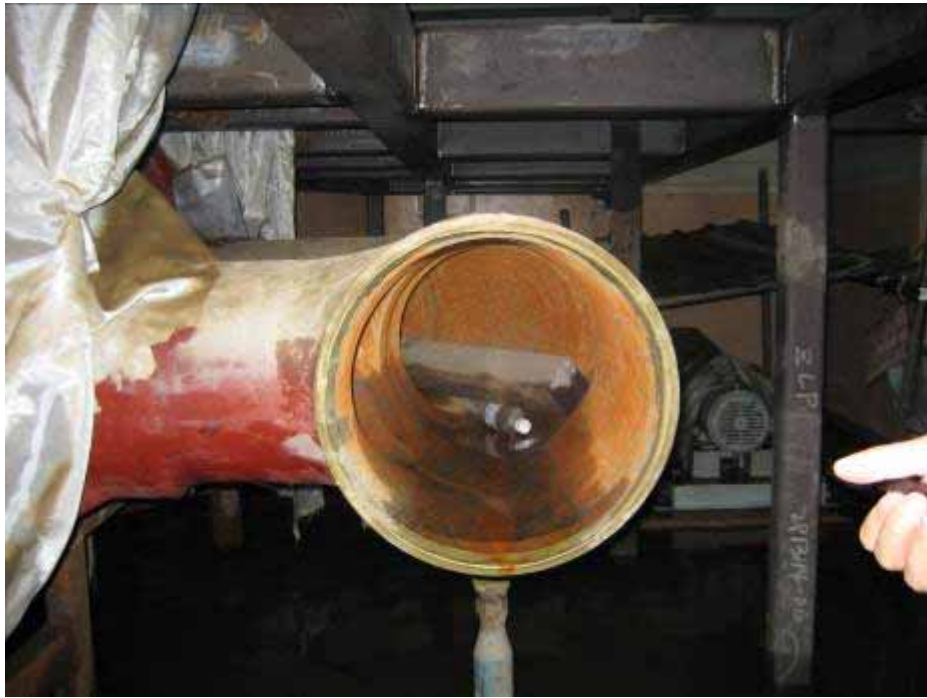
圖十三 部分管節淹水後淤泥狀況
